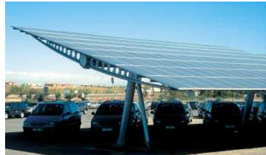
Kuva 4.28: Photocampa, Tarragona, Espanja. Autokatokseen integroitu aurinkosähköjärjestelmä [24].
