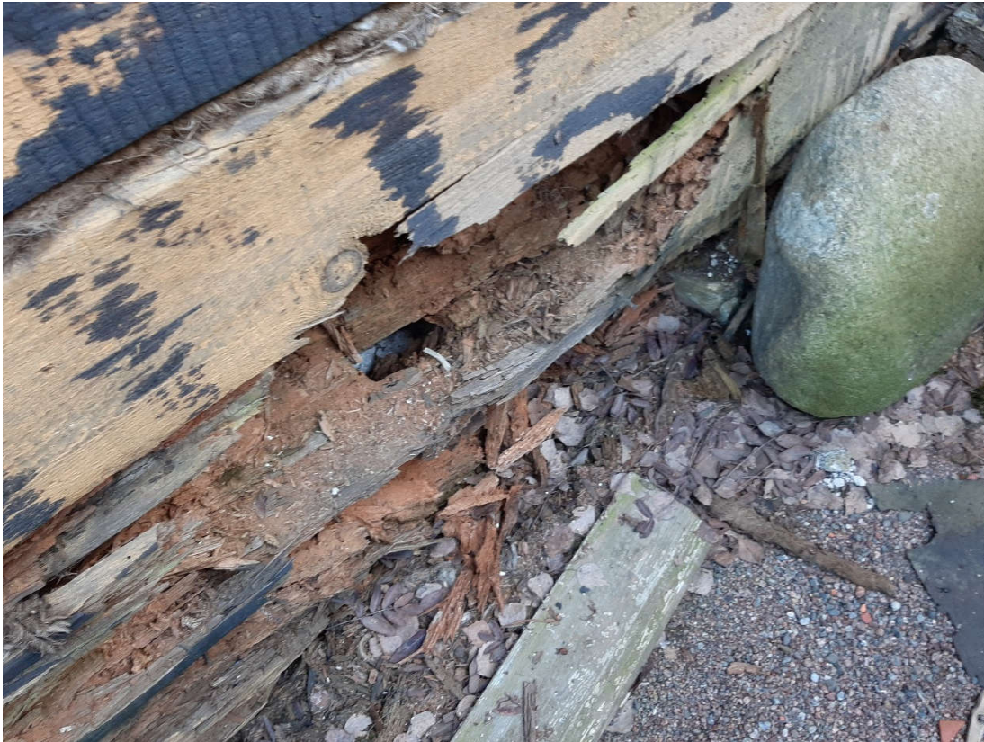
Kuva 8. Vauriota ulkoseinärakenteen alaosa.
