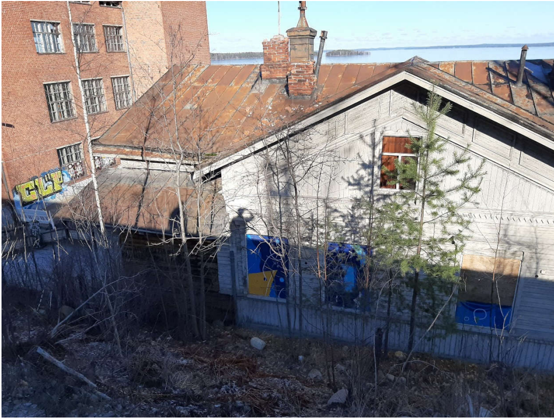
Kuva 13. Vesikatteen ja piippujen kunto on huono.
