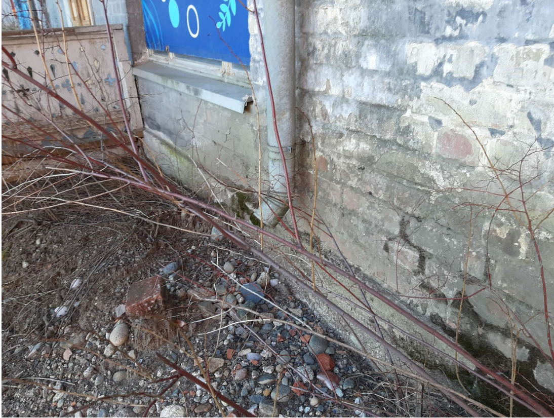
Kuva 4. Kuvaa perustuksiin aiheutuneesta kosteusrasituksesta.
