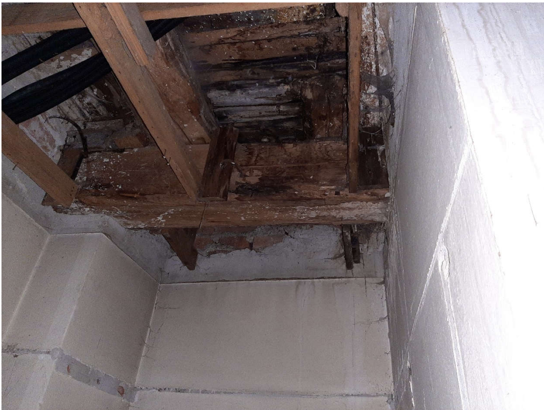
Kuva 12. Kosteusvauriojälkiä välipohjan alapinnassa.
