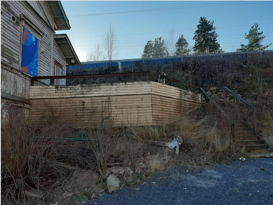
Kuva 3. Päädyn terassi on huonokuntoinen ja vaarallinen.
