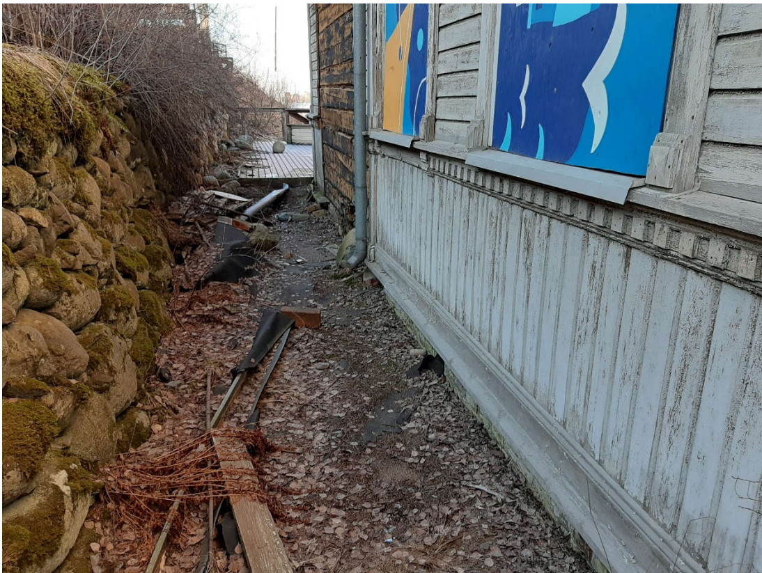
Kuva 9. Ylärinteen puolella ulkoseinän alaosan kosteusrasitus on kova.
