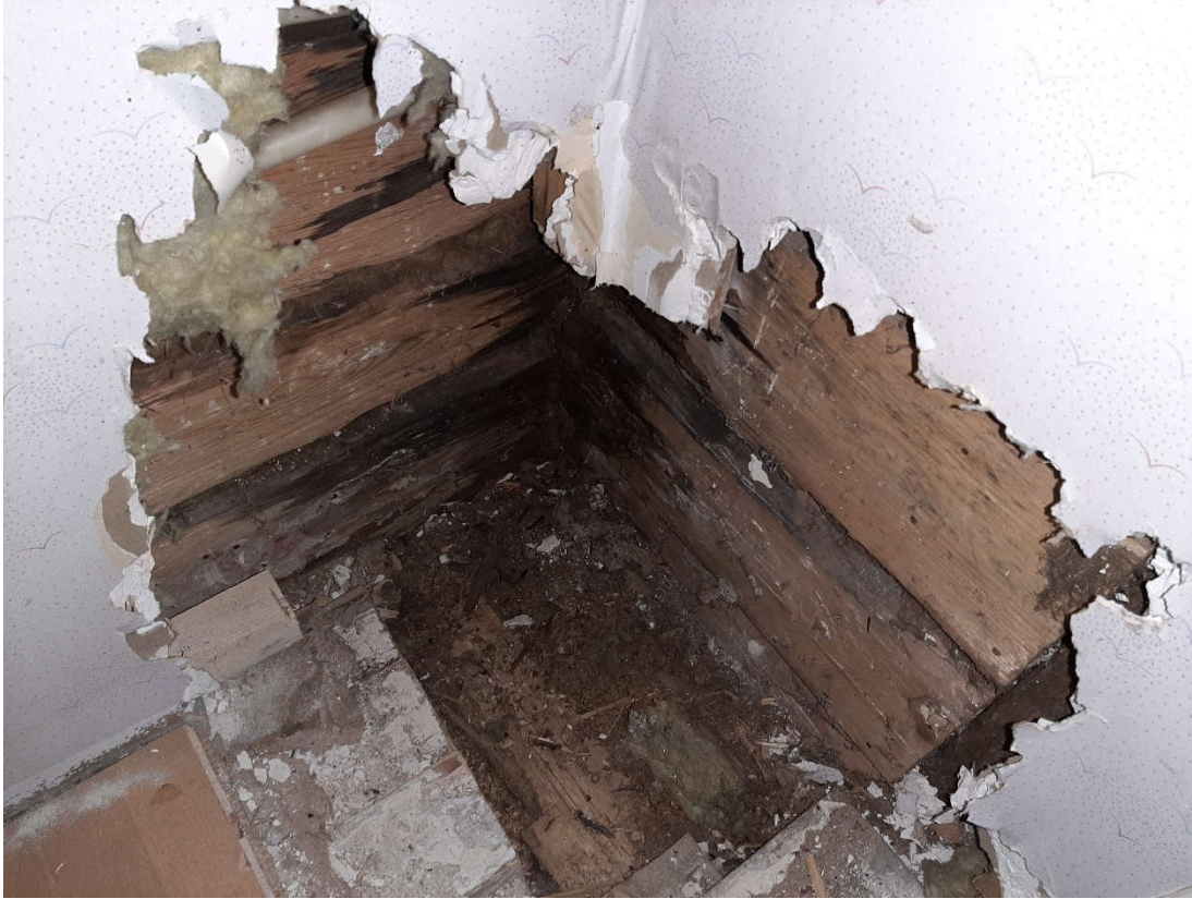
Kuva 5. Kuvaa ulkoseinän vaurioista rakennuksen sisällä.
