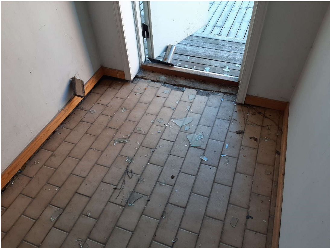
Kuva 6. Tuulettuva alapohjarakenne on paikoin painunut.
