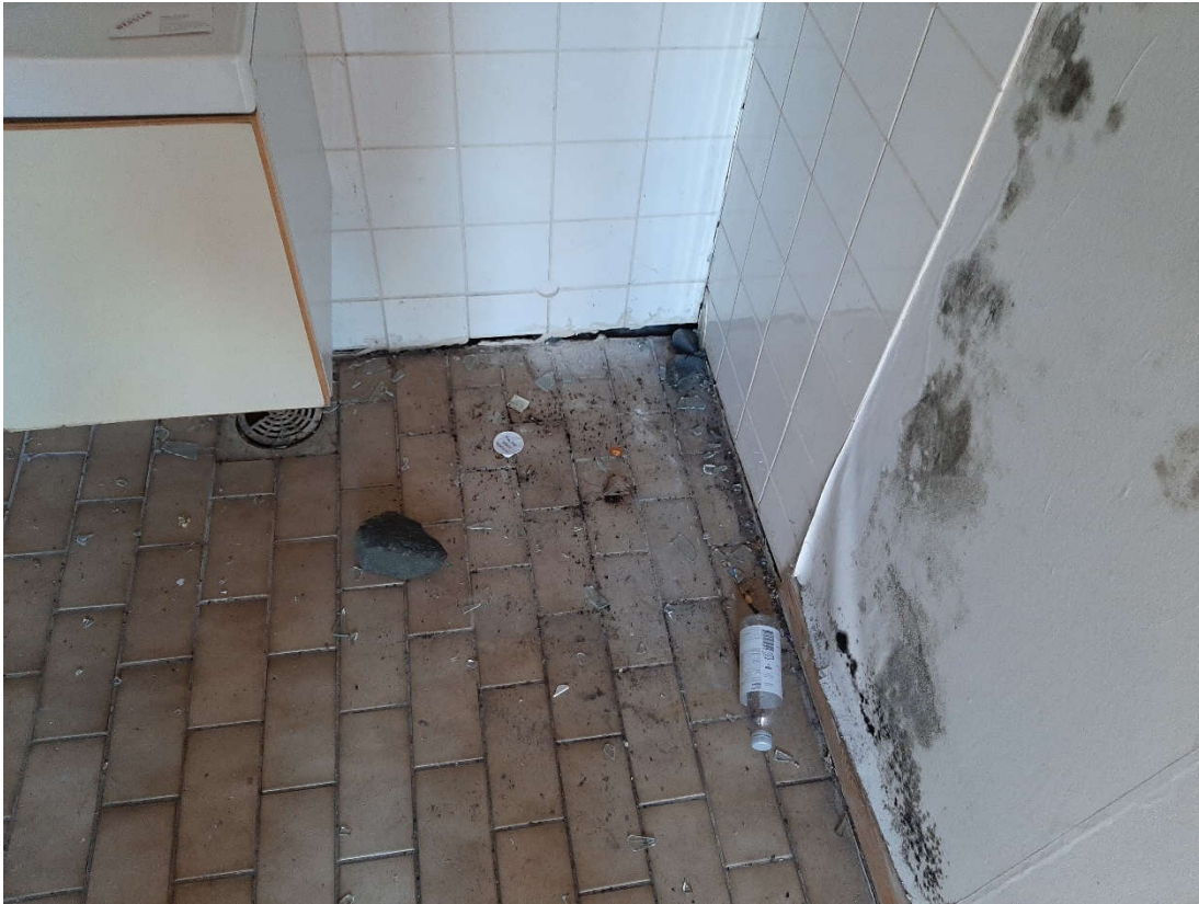
Kuva 15. Homekasvustoa sisätilojen pintarakenteissa.
