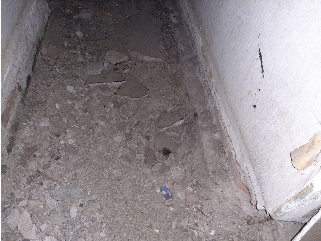
Kuva 7. Maanvarainen alapohja tulisi uusita kokonaisuudessaan.
