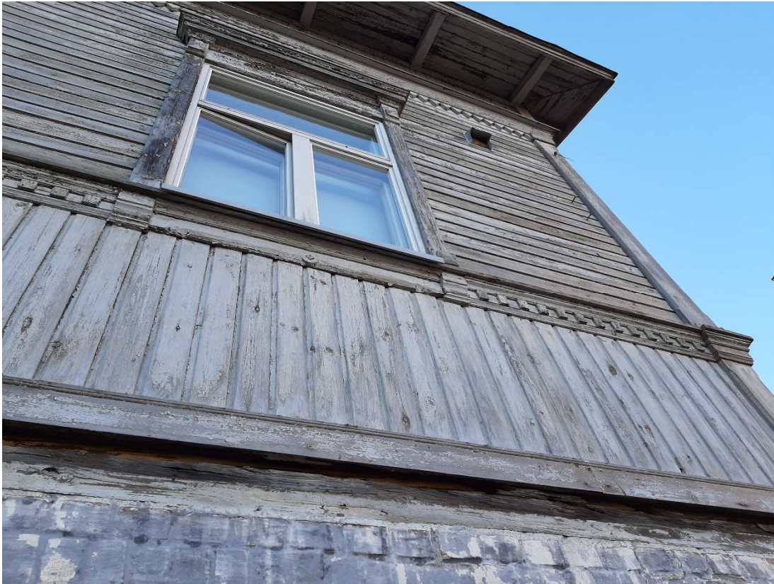
Kuva 10. Ulkoverhouksen kunto on huono. Vauriota havaittavissa seinän alaosassa.
