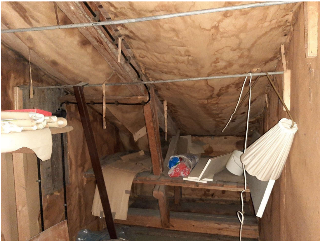
Kuva 14. Kosteusjälkiä vesikaton rakenteissa ullakolla.
