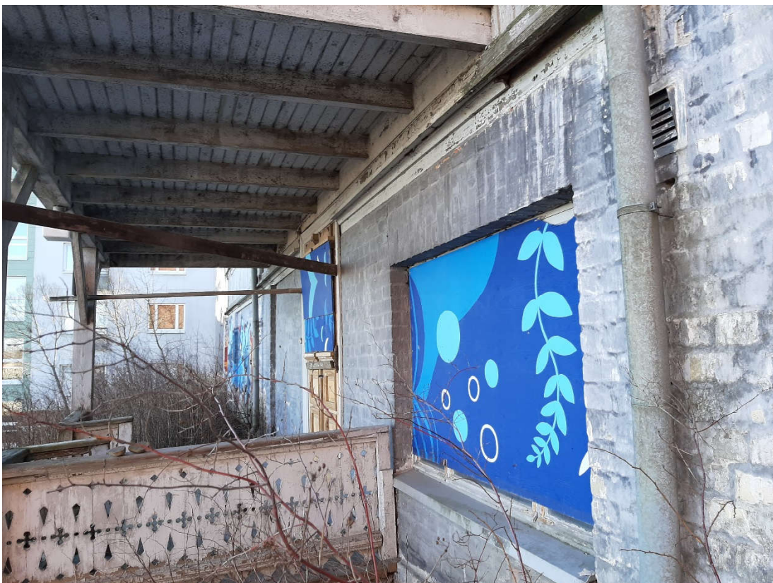
Kuva 2. Parvekkeen ja alapuolisen terrassin rakenteet tulisi uusia.
