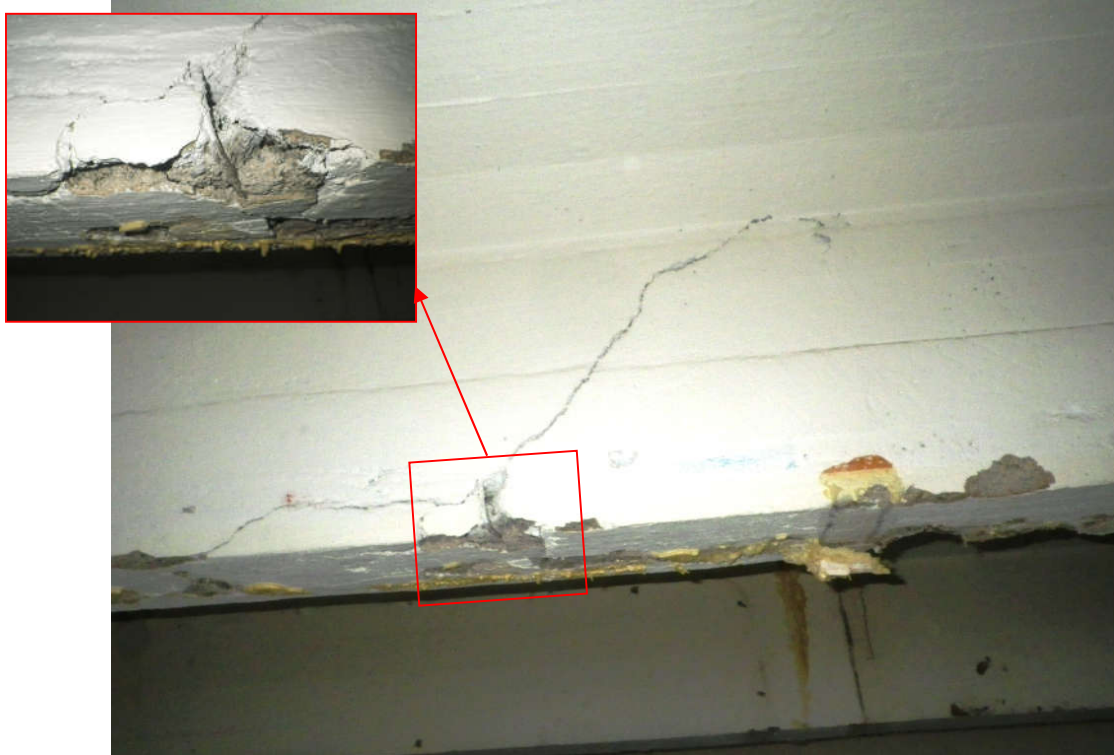
Kuva 21. Halkeama pahvitehtaan välipohjan sekundääripalkissa. Teräkset pinnassa. Halkeama viittaa palkkiterästen myötämiseen
