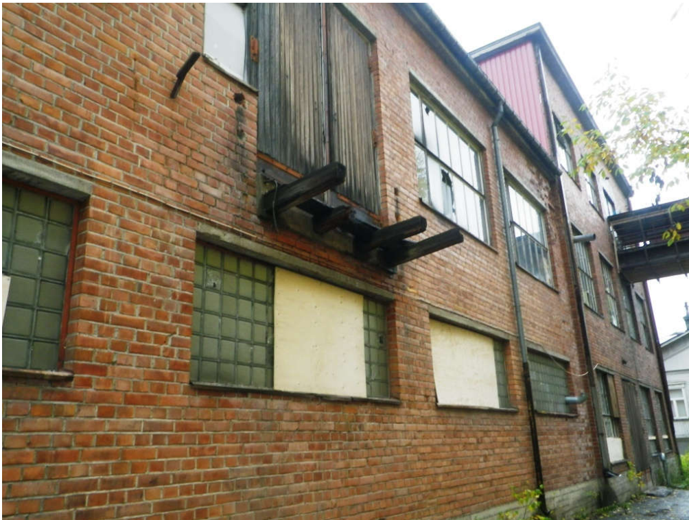
Kuva 2. Yleiskuvaa puhvitehtaan pohjoisjulkisivusta; kantavat seinät ovat tiilimuureja ja –palkkeja. Ikkunoiden huolto on jäänyt tekemättä, eikä niiden kunnostaminen ole enää järkevää
