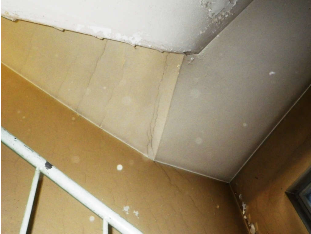
Kuva 27. Halkeamavaurioita porrashuoneen syöksyssä sekä seinässä
