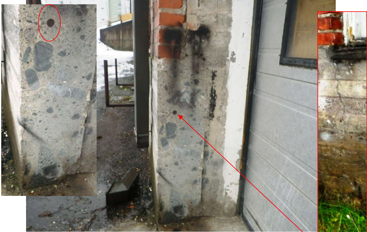
Kuva 3. Sokkelin rakennetta ovelle leikatun aukon kohdalta: sokkelin raudoituksena on vain yksi järeä pyöröteräs. Sokkelissa on yleisesti halkeamia
