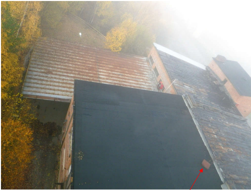
Kuva 32. Lastaussillan kateen pintakorroosiota. Lappeen luukun kautta otettiin yläpohjan lämmöneristeen mikrobinäytteet
