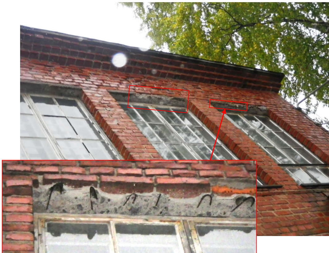
Kuva 8. Pintarapautumaa räystään alapuolisessa muurauksessa. Betonisessa ikkunanylityspalkissa runsasta rapautumaa (det; pannuhuone)
