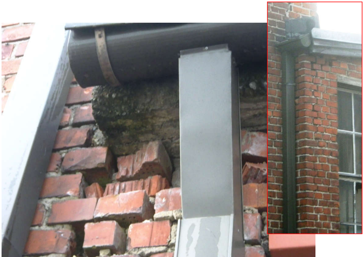
Kuva 10. Hulevesivuotojen aiheuttamia muurauksen vaurioita räystäillä
