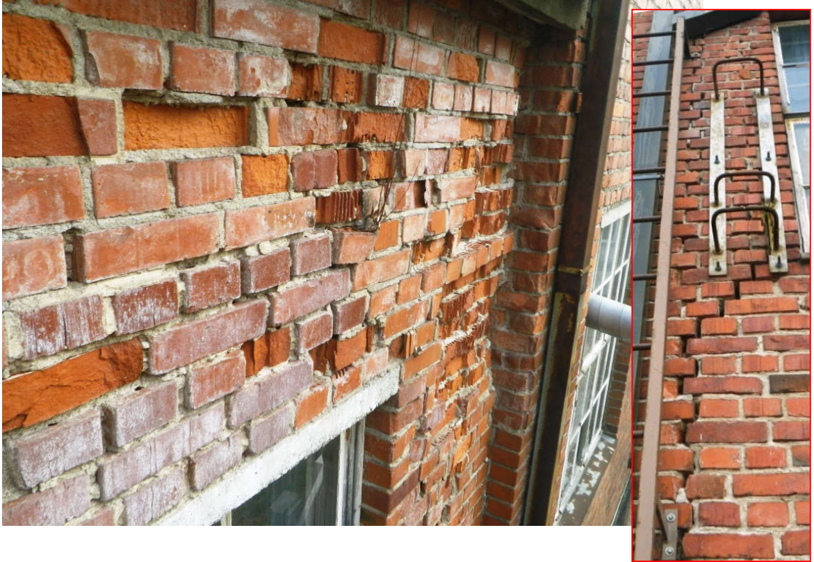
Kuva 5. Rapautunutta tiilijulkisivupintaa rautatien puoleiselta (pohjois-)julkisivulta. Eteläjulkisivun pystyhalkeama (det)
