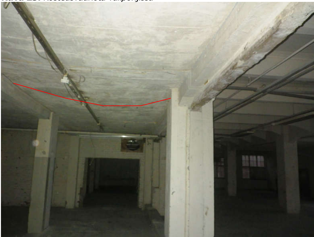
Kuva 24. Ylisuuri taipuma betonilaatassa on viite terästen / terästyksen ankkuroinnin myötäämisestä. Välipohjien sekundääripalkkien välisillä alueilla todettiin myös runsasta taipumaa ja yläpuolella halkeamat sekundääripalkkien kohdalla. Myös tämä on viite terästen/ terästyksen ankkuroinnin myötäämisestä.
