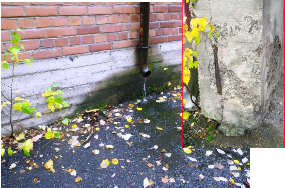
Kuva 7. Sadevesien edelleen johtaminen seinän viereltä ei ole asianmukainen (yläpuoli): kastelee alapuoisten kerrosten maanpainesieniä. -Teräskorroosion halkaisemaa sokkelin päätä (det)
