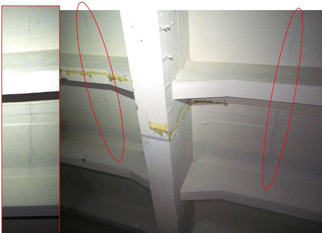
Kuva 22. Välipohjalaatassa on molemmin puolin primaaripalkkia halkeamat (ulkoseinästä vastakkaiseen ulkoseinään)
