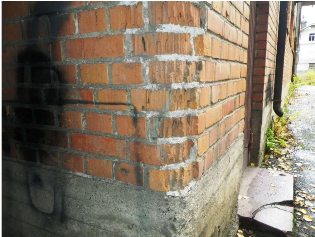
Kuva 6. Pahvitehtaan julkisivutiilet ovat reikätiiliä (myös umpitiiliä tavattiin tutkimuksen aikana). Ulkokulman (mekaanisia) vaurioita
