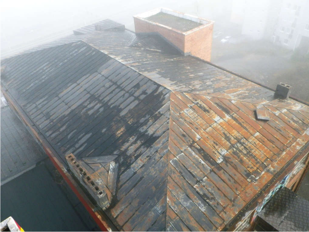
Kuva 31. Yleiskuvaa korkeimman osan konesaumattusta peltikatteesta. Maalipinnoitteet kuluneet ja kateen pinnassa on ruostetta. Pinnoitteessa todettiin haitallisen suuria PAH pitoisuuksia
