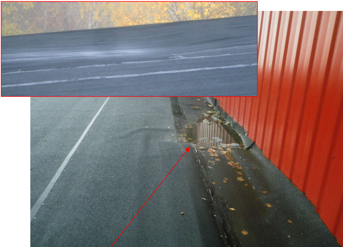
Kuva 28. Lammikoitumista vesikatteen pinnalla: todennäköisesti alapuolisen puurakenteen lahovaurio. Painuma myös lappeen toisessa reunassa (det)
