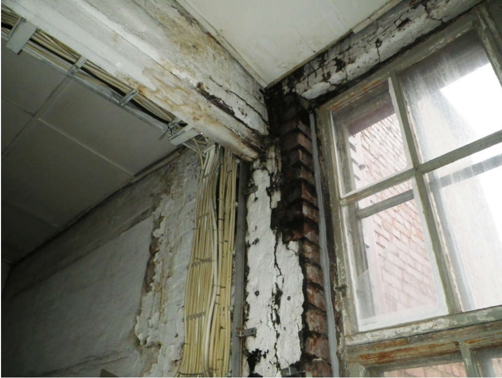
Kuva 17. Itäpuolen hissien lähellä 4. ja 5 kerroksessa on ollut pitkään vuotovaurio vesikatolta. Molemmissa kerroksissa kyseisellä kohdalla todettiin tiilien mikrobivaurioitumista
