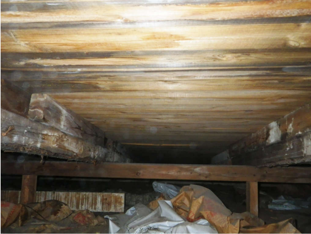
Kuva 29. Vesikatteen alapuolen puurakenteissa runsaasti vuotojälkiä (pulpettikatto)
