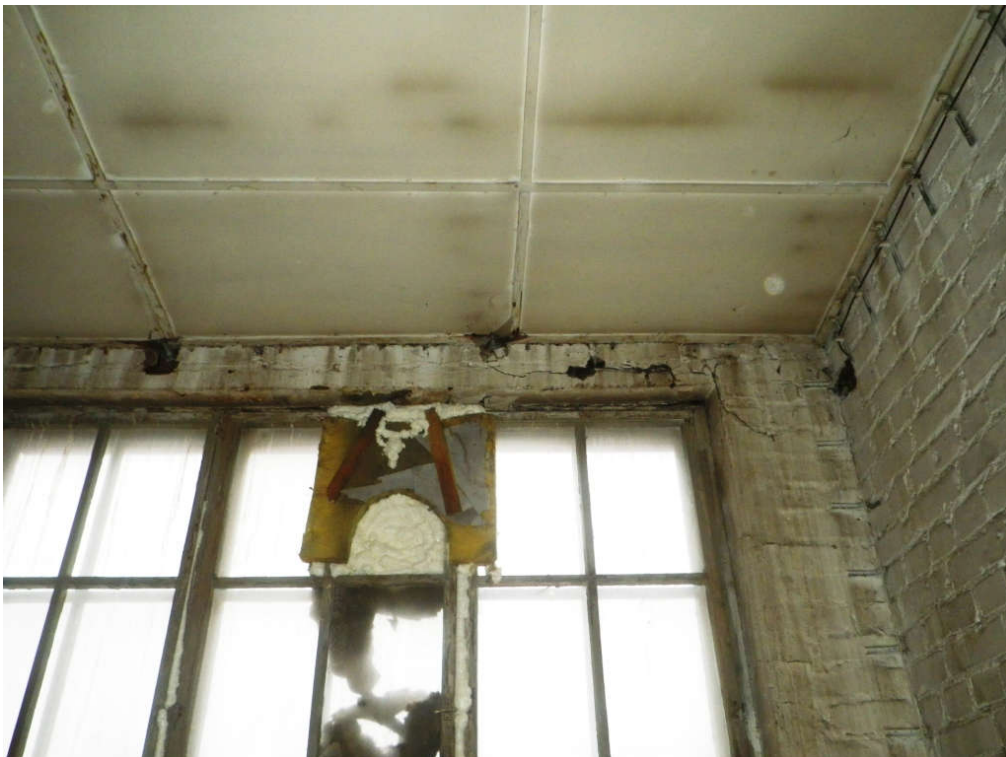
Kuva 20. Pannuhuoneen seinän / katon liittymän vuotovaurioita
