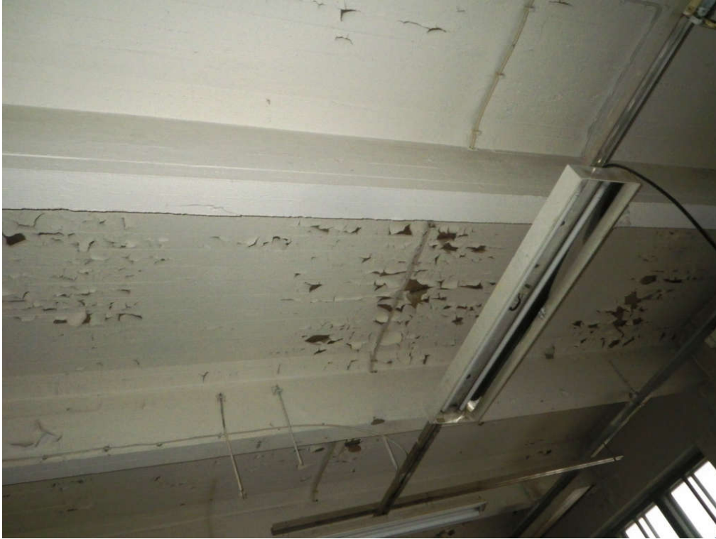
Kuva 25. Viitteitä välipohjien kosteusvauriosta; maali hilseilee
