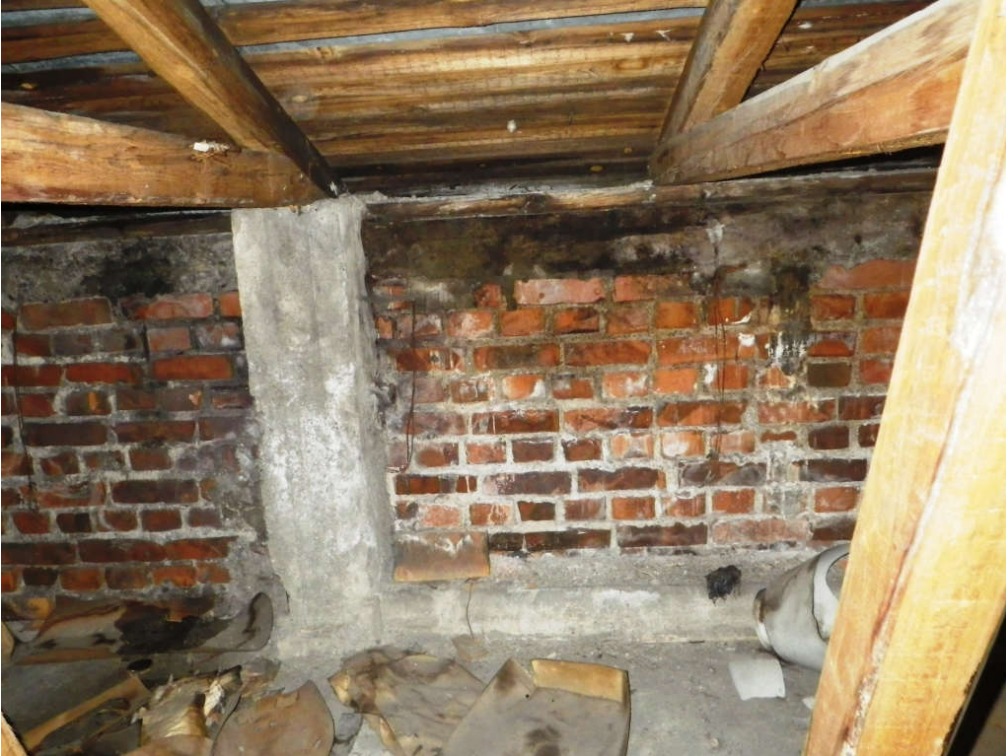
Kuva 30. Vesikatteen alapuolen rakenteissa runsaasti vuotojälkiä (korkea osa)
