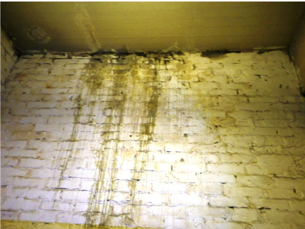
Kuva 18. Länsipäädyssä maanpainesinän tiiviys ei ole riittävä; vuotojälkiä
