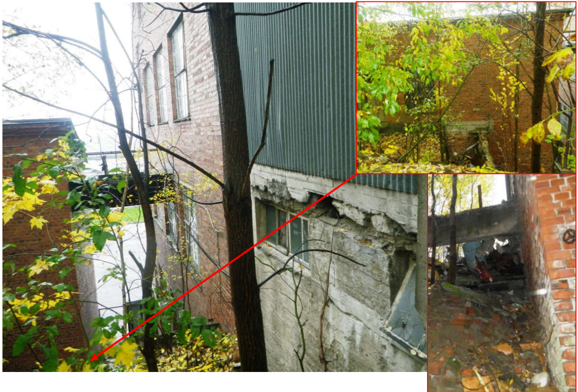
Kuva 15. Pahvitehtaan länsiseinää (pannuhuonetta vasten). Vaurioita betoniseinässä. Pannuhuoneen pohjoispuoleista tiiliseinää kuormittaa maan- sekä vedenpaine (det)
