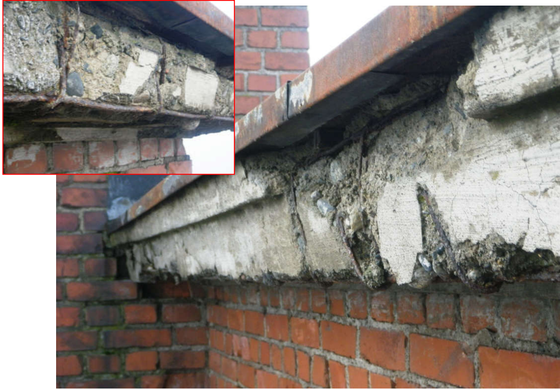
Kuva 9. Betonisen räystään terästyksen korroosiovauriot sekä betonin rapautuminen ovat yleisiä vesikaton reunan alla
