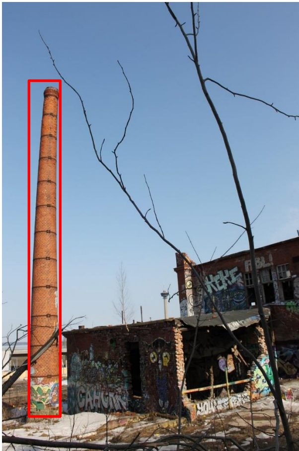
Kuva 5.6 Tulitikkutehtaan kallistunut piippu kuvattuna lännestä 15.4.2018
