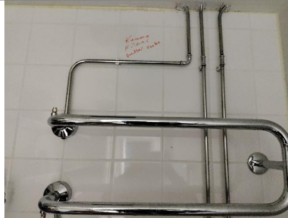
Siivouskomeron käyttövesipatteri vuotaa. Lämpimän käyttöveden kierto suljettu tilassa.
