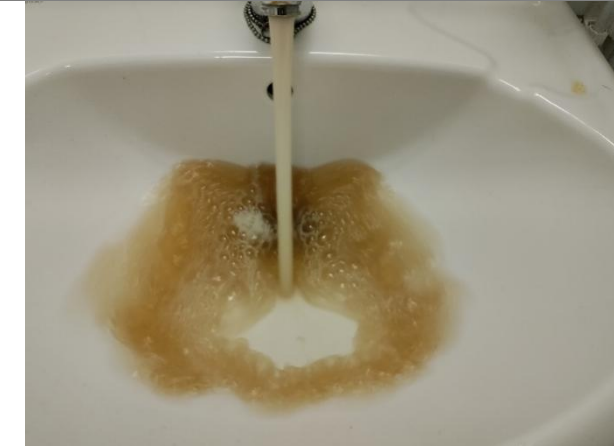
Rakennus on ollut pitkään ilman käyttöä, joten putkistosta irtoaa sakkaa värjäten veden ruskeaksi.
