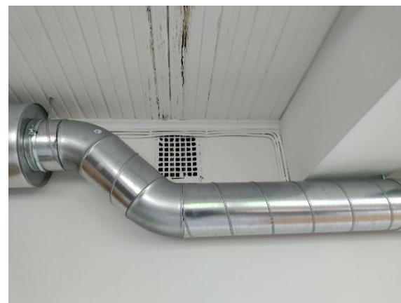
Avonainen ritiläsäleikkö 3. kerroksessa.
