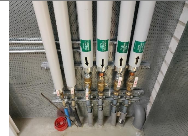
TK1 ja TK2 ilmanvaihtokoneiden lämpöjohdot 1. kerroksen konehuoneessa.
