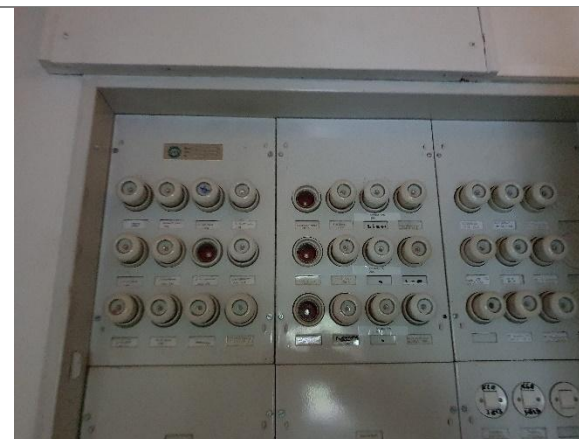
Keskuksessa R2 puuttuvia kosketussuojauksia
