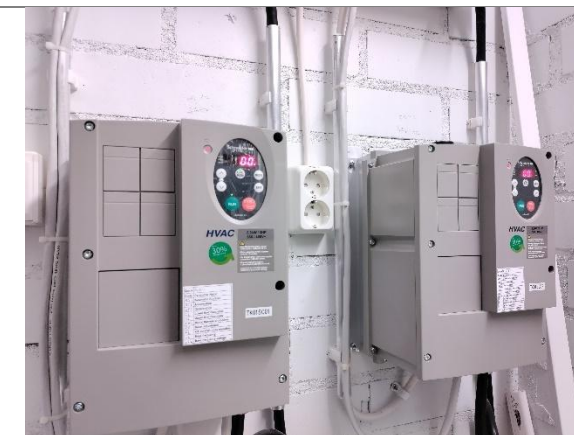
TK1 puhaltimien taajuusmuuttajat.
