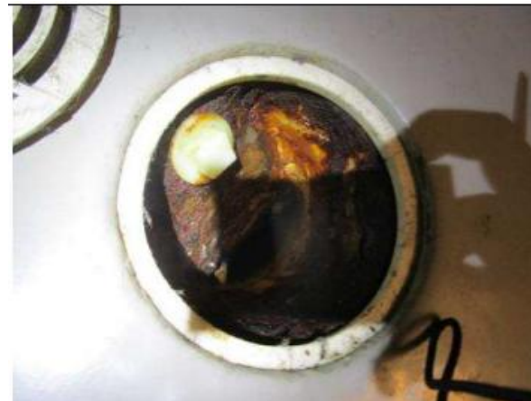
Vanha valurautainen lattiakaivo syöpynyt. Rasi- tulppa tallessa.
