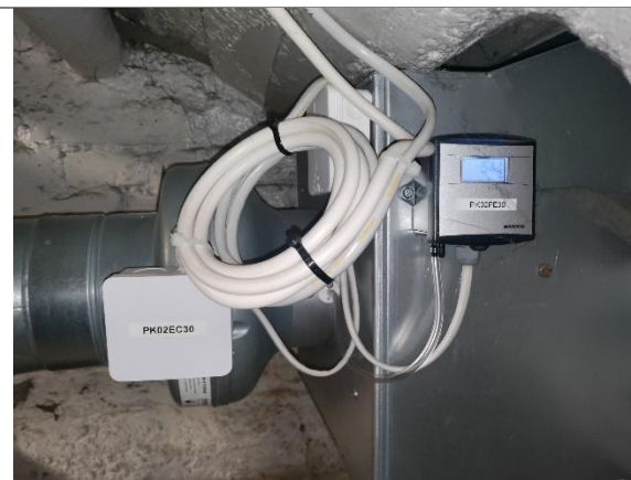
Kellarin kanavapuhallin ja paine-eromittari
