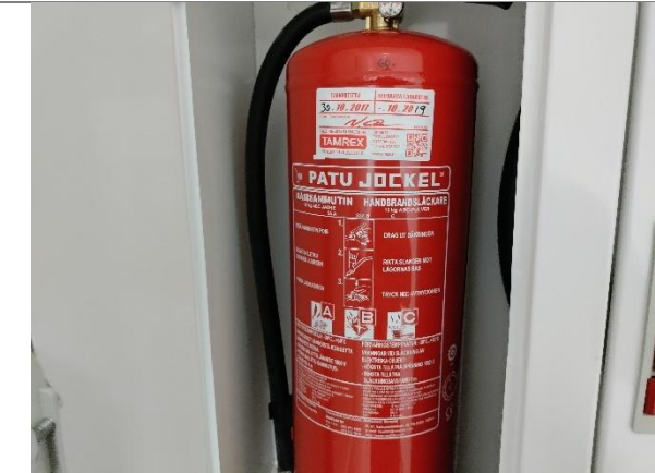
Käsiammuttimien tarkastukset tehty viimeksi 2017, jotka ovat vanhentuneet 2019.
