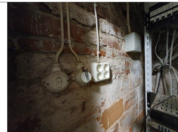
Kellaritilan uusia ja vanhoja sähkökojeita
