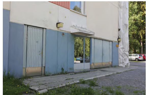
Kuva 37. Torni 4 (8D) pesulan sisäänkäynti on pienen lipan alla. Lippa on linjassa ylemmän kerroksen ikkunan kanssa.
