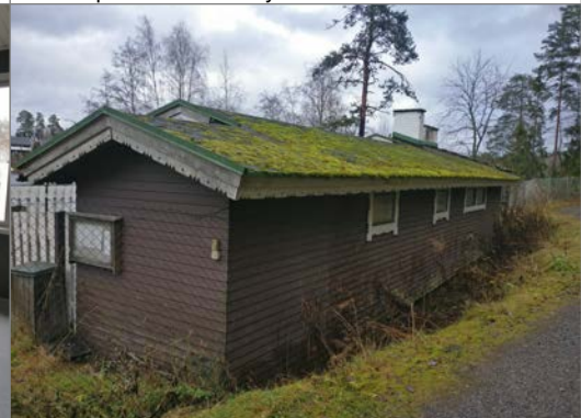
Maastonmuodot keräävät lunta ja vettä rakennukset julkisivulle
