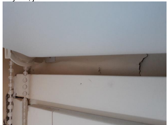
Kuva 18 Ikkunoiden yläosissa on halkeamia ja epätiivitä liittämiä.
