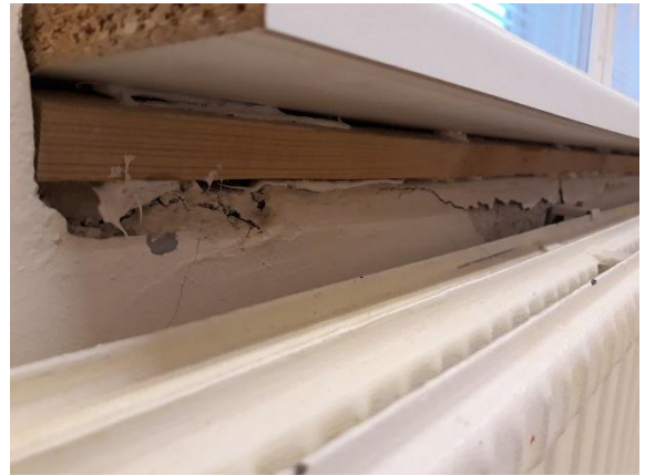
Kuva 16 Ikkunalaudan alapuolella on epätiivitä rakenneliittymiä, joka mahdollistaa ilmavuodot.
