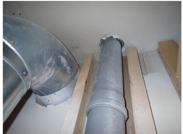
Kuva 32 Tilaan 120 sijoitetulla ilmanvaihtokoneen kohdalla yläpohjan läpivienti on epätiivis.
