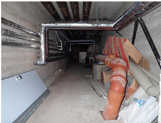
Kuva 25 Putkikanaalissa on rakennusjätettä.
