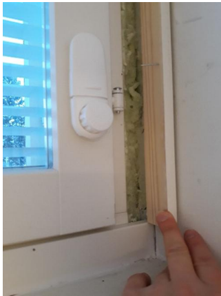
Kuva 15 Vuonna 2017 asennettujen ikkunoiden tilkeraossa on uretaanivaaho.
