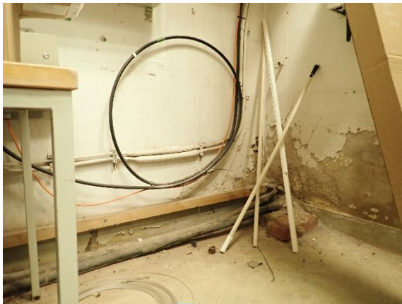
Kuva 5 Lämmönjakohuoneen maanvastaisissa seinärakenteissa runsaasti maalin hilseilyä.
