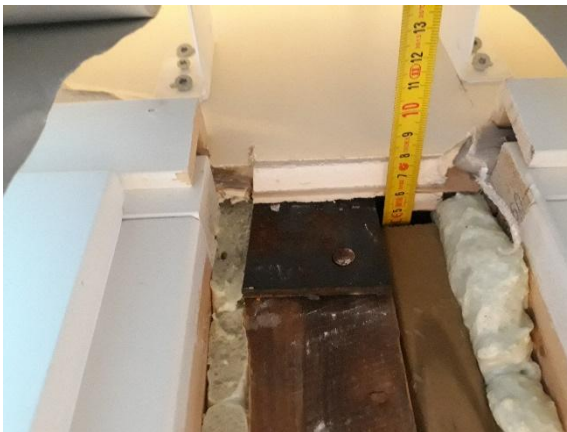
Kuva 17 Ikkunoiden väliset puurakenneliittymät eivät ole tiiviitä ja niissä on huomattavia rakoja.
