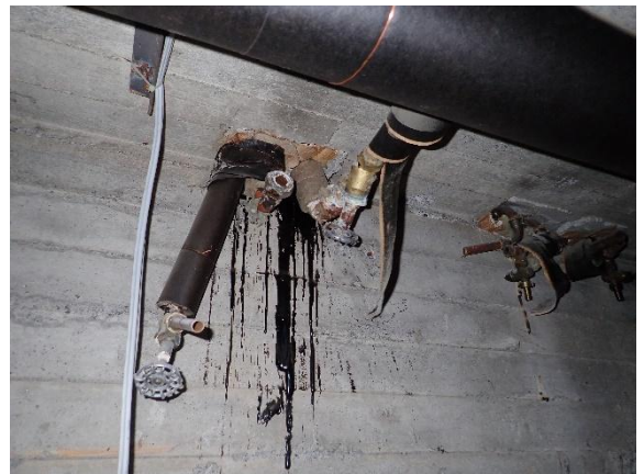
Kuva 26 Putkikanaalissa on runsaasti käytöstä poistettua tekniikkaa, joiden läpiviennit eivät ole tiiviitä.
