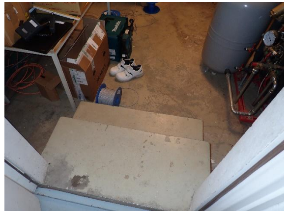
Kuva 11 Lämmönjakohuoneen lattiatpinta on muita tiloja alempana. Lattiatpinnoite on ikääntynyt.
