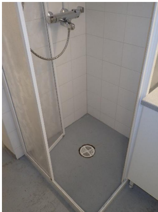
Kuva 10 Kellarin pukuhuoneessa K06 on suihku, jossa lattiatpinnoite (maali) on laajasti vaurioitunut.
