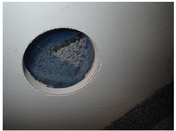
Kuva 2 Ulkoseinän rakenneavaus käytävällä 153 (n. 30 cm korkeudella). Kipsilevyn takana ilmarako, höyrynsulkumuovi ja kevytsorabetoniharkko.
