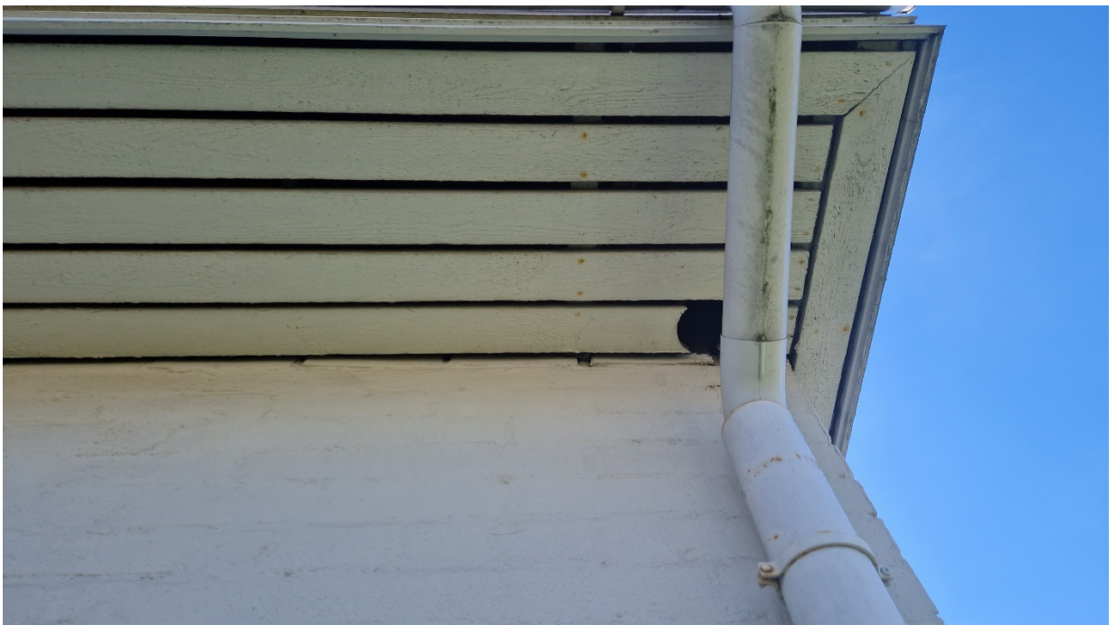
Kuva 6. Räystäslaudoitus on rakolaudoitusta, josta on rakojen välistä lepakoilla pääsy välikattoon. Myös räystäslaudoituksen päällä on eristevilla.
