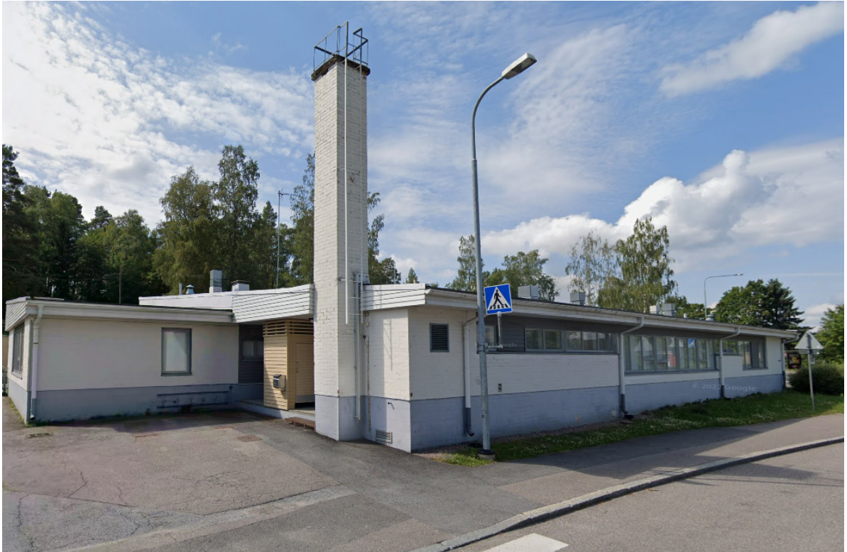
Kuva 7. Lämmityskattilan vanha savupiippu on hatuton. Piippu ei ole käytössä.
