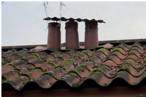
Päiväkoteja yhdistävän katoksen katto on asbesti-pitoista mineriittä. Kuva SHi.
