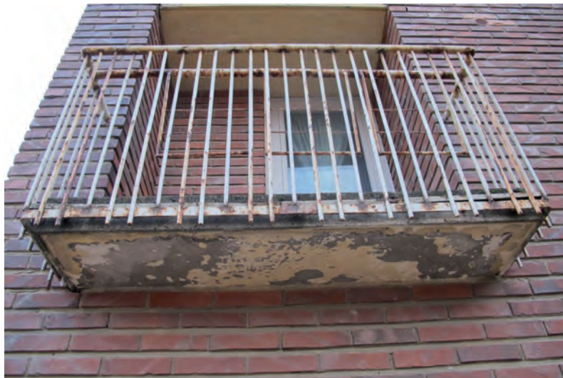
Kalevan päiväkodin parvekkeen betonilaatta on kärsinyt kosteudesta. Teräskaide on ruostunut. Kuva SHi.
