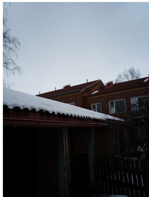
Yhdyskäytävän asbestipitoinen varttikate. Muuten katemateriaalina on pääosin tiili.
