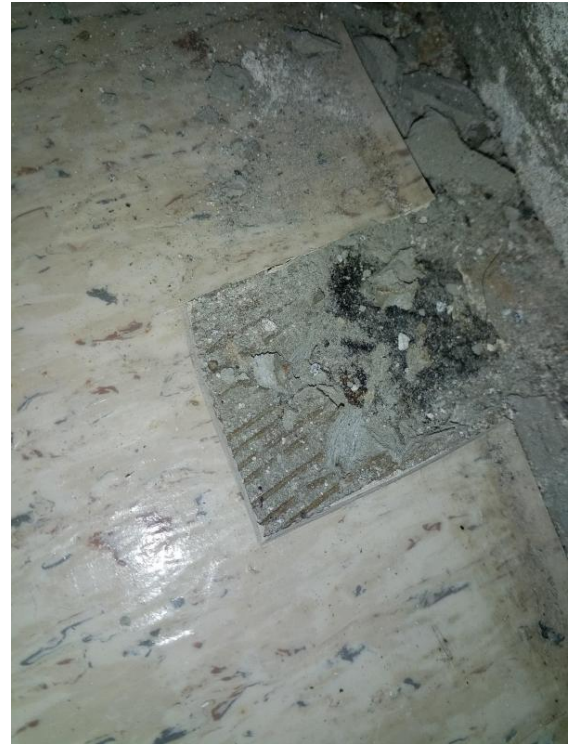
Tilan 101 nykyisen lattiamaton ja tasoitteen alla asbestipitoista mustaa pikiliimaa.
