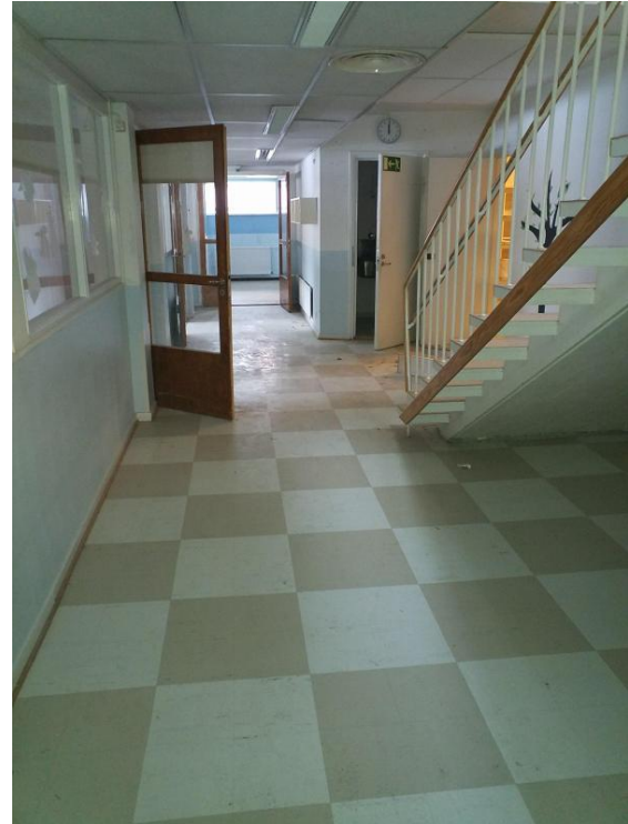
Tilan 052 Finnflex-laattaa, 250mm x 250mm → sisältää asbestia.
