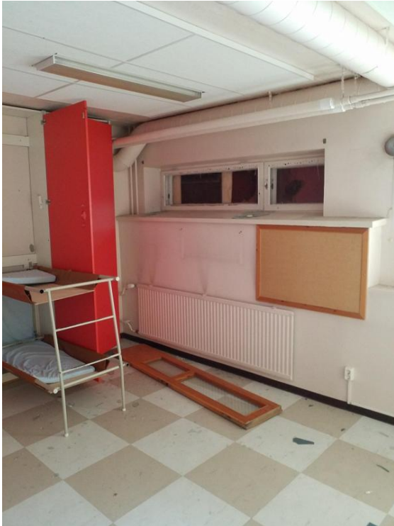
Tilan 054 lattiassa Finnflex-laattaa, 250mm x 250mm → sisältää asbestia.
