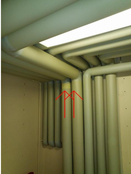
Tilan 040 vesi- ja lämmitysputkia. Nuolella merkityt putket ovat asbestieristeisiä, mutta verhoiltu muovisuojalla.
