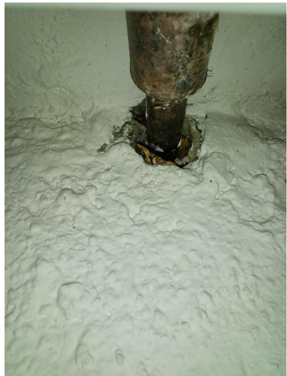
Teräsvesi/ lämpöputkien alkuperäisiä asbestieristeitä on paikoin poistettu, mutta läpivientien kohdille asbestipitoisia eristeitä on jätetty. Kuva on tilasta 076.
