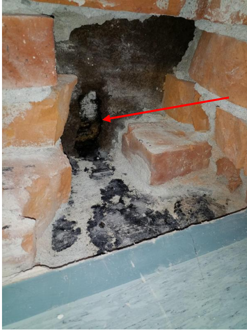
Tilan 001 ulkoseinän bitumisivelystä otettiin näyte 18 → sisältää asbestia. Asbestipitoista bitumisivelyä vasten on korkkieriste, jota tulee myös käsitellä asbestipitoisena, koska se on osittain kiinni sivelyssä.
