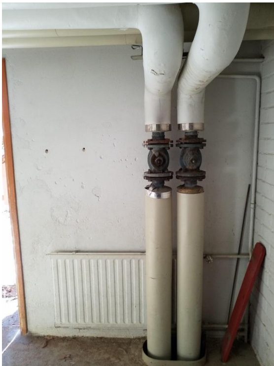
Kuva tilasta 011, jossa yläosan putkieristeet ovat asbestipitoisia ja alaosan eristeet villaeristeiset.
