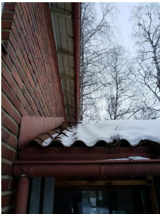
Yhdyskäytävän asbestipitoinen varttikate.
