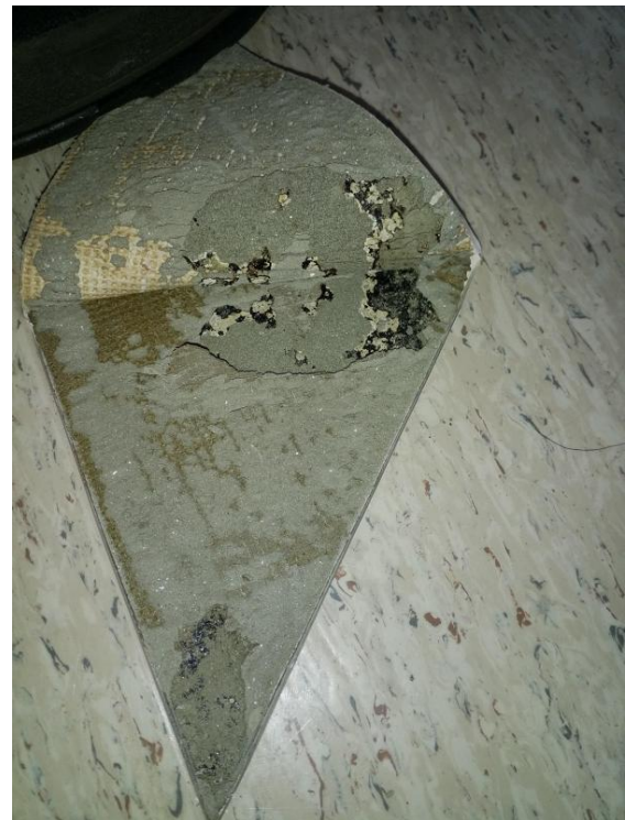
Tilan 116 nykyisen lattiamaton ja tasoitteen alla asbestipitoista mustaa pikiliimaa.
