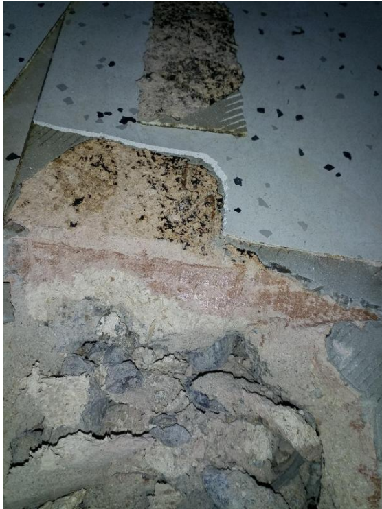
Tilan 016 lattian punaisesta ja valkoisesta massasta otettiin näyte 14 → sisältää asbestia. Tilassa lisäksi asbestipitoinen musta pikiliima.
