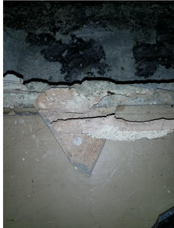
Tilan 053 lattiassa havaittiin näytettä 14 vastaavaa asbestipitoista punavalkoista lattiamassaa.
