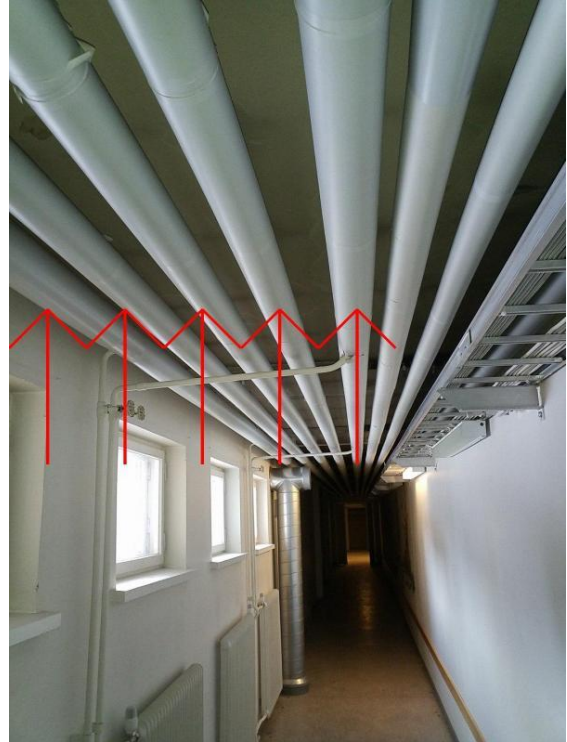
Yhdyskäytävällä 044 nuolilla merkityt putket ovat asbestieristeisiä ja suojattu muovisuojalla.
