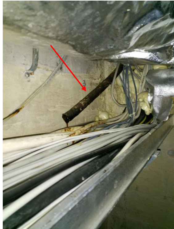
Rakennuksessa havaittiin yksittäisiä vanhoja sähköputkia, jotka sisältävät PAH-yhdisteitä.
