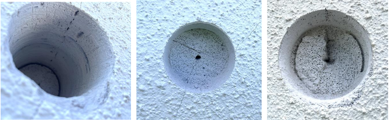
Kuvat 18 a-c. Rakenneavaukset alkuperäisosan kevytbetonielementtiin. Kuva a: Rakenneavaus RA1. Kuva b: Rakenneavaus RA5. Kuva c: Rakenneavaus RA10. Kaikissa avauksissa julkisivuissa olevien halkeamien havaittiin jatkuvan syvemmälle kevytbetonielementtiin, avaukset tehtiin ~50...115 mm syvyyteen.
