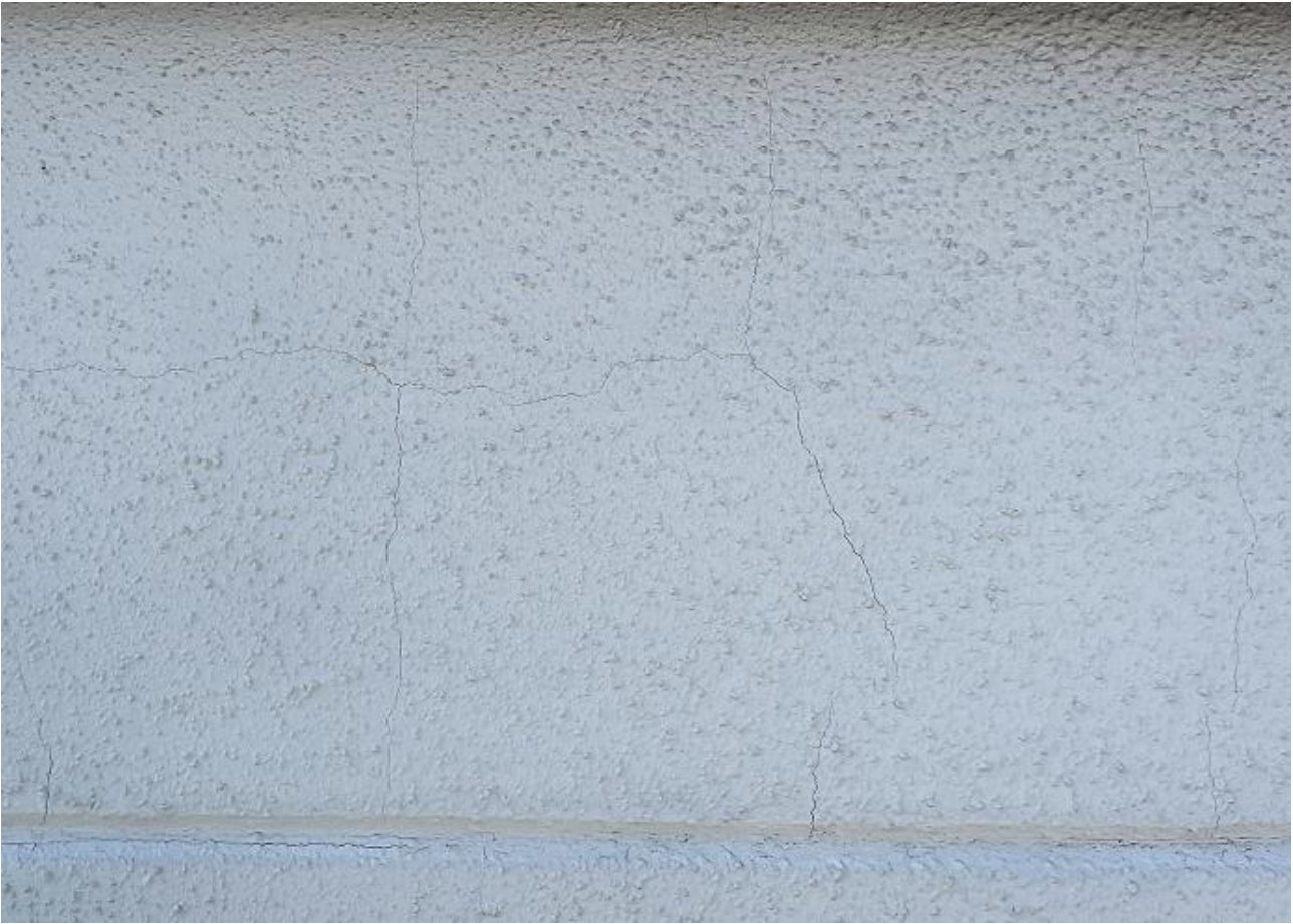
Kuva 31. Kevytbetonijulkisivuissa havaittiin runsaasti hiushalkeamia eri puolella rakennusta.
