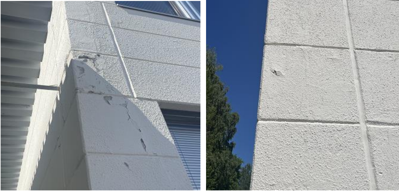
Kuvat 33 a ja b. Nurkka-alueilla havaittuja rapautumavaurioita.
