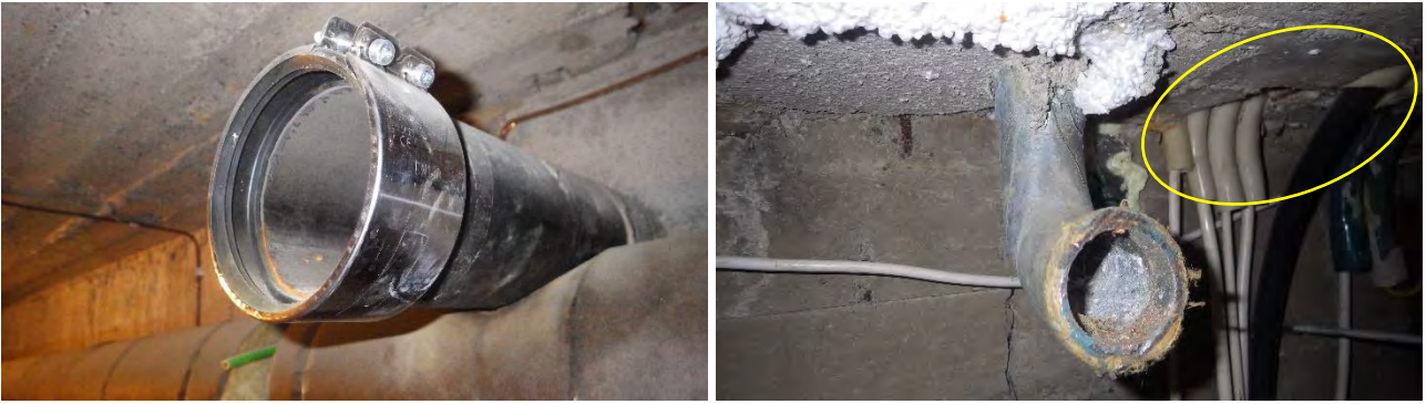
Kuva 75 a-b. a) Putkitunnelissa useita tulppaamattomia käytöstä poistettuja putkia. b) Tunnelissa useita epätiivitä läpivientejä 1. kerrokseen.
