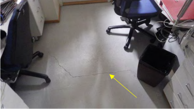
Kuvat 18 a-c. a) Kohonneita pintakosteusilmmaisimen arvoja seinälinjalla tilassa 110E. b) IV-konehuoneen lattiassa 136D kohonneita pintakosteusilmmaisimen arvoja. Ko. kohdassa todennäköisesti tehty rakennuksen historian aikana joitakin rakenteellisia muutoksia. c) Tilassa 205B pintalaatassa halkeama.
