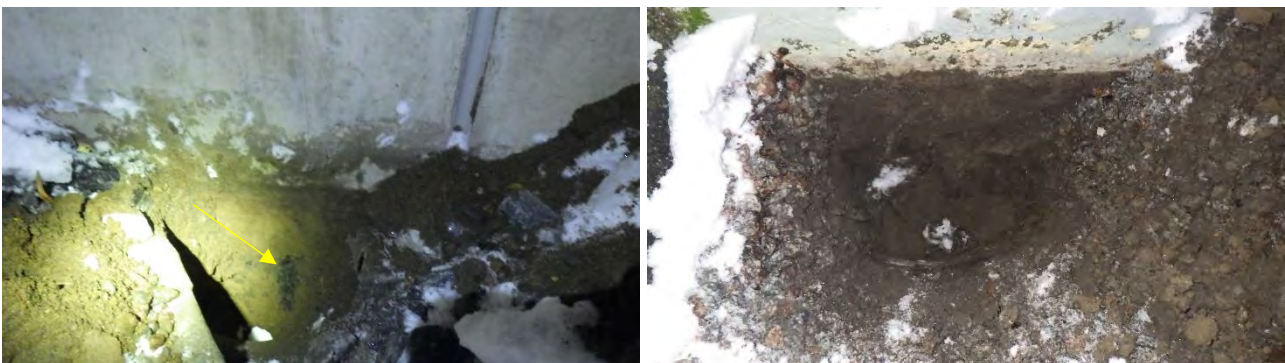
Kuvat 36 a-b. a) Tilan 110E kohdalle tehdystä kaivannosta havaittiin perusmuurin ulkopinnalla ohut bitumisively (keltainen nuoli). b) Tilan 131C kohdalle tehdystä kaivannosta (syvyys n. 500 mm) ei havaittu perusmuurissa ulkopuolista vedeneristettä.
