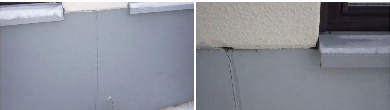
Kuvat 7 a-b. a) Lähes jokaisessa sokkelin saumakohdassa on halkeilua. b) Sokkelien ja ulkoseinän kevytbetonilankkujen välissä myös paikoin rakoja.
