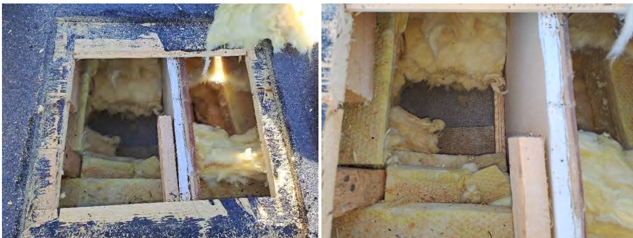
Kuvat 52 a-b. a) Rakenneavaus RA-YP2 rakennuksen E-osalla. b) E-osalla palo-osastointi. Villan alla ei ole höyrynsulkumuovia.
