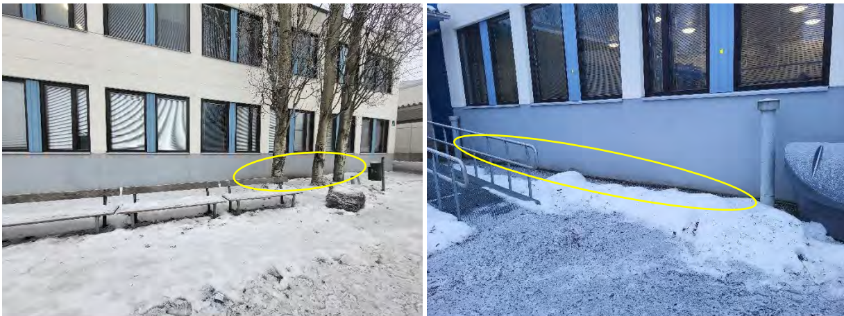
Kuvat 5 a-d. a) Puiden kohdalla rakennuksen itäpuolella sokkelissa tummentumaa. b) A-osan opettajanhuoneen kohdalla sokkelissa merkkejä kosteusrasituksesta. Ko. kohdassa sokkelin ja asfaltoinnin välissä rakoja.
