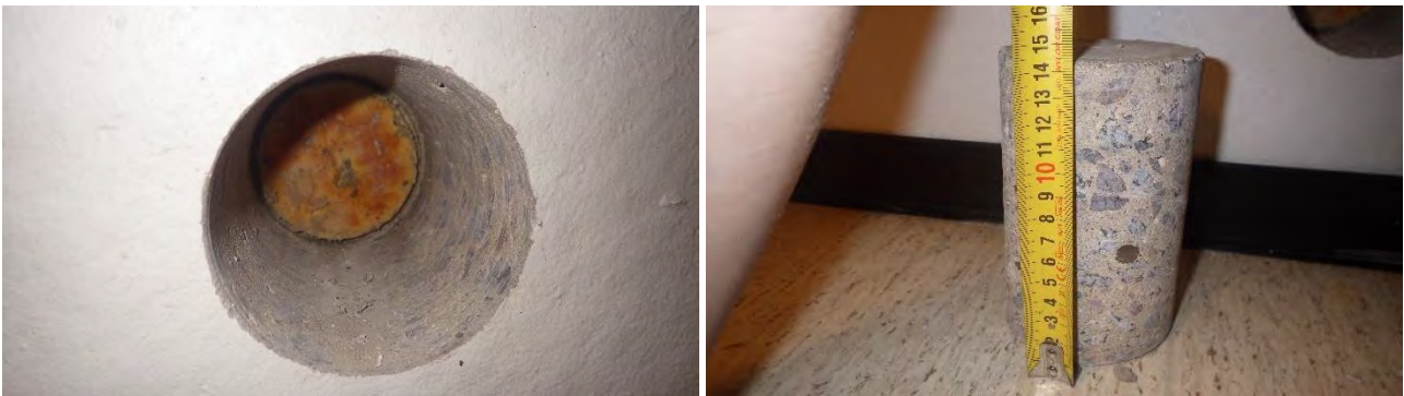
Kuvat 35 a-b. a) Rakenneavaus RA-MVS3. Eristeenä polyuretaanilevy. b) Sisäkuoren pak- suus maanvastaisessa seinässä noin 140 mm.
