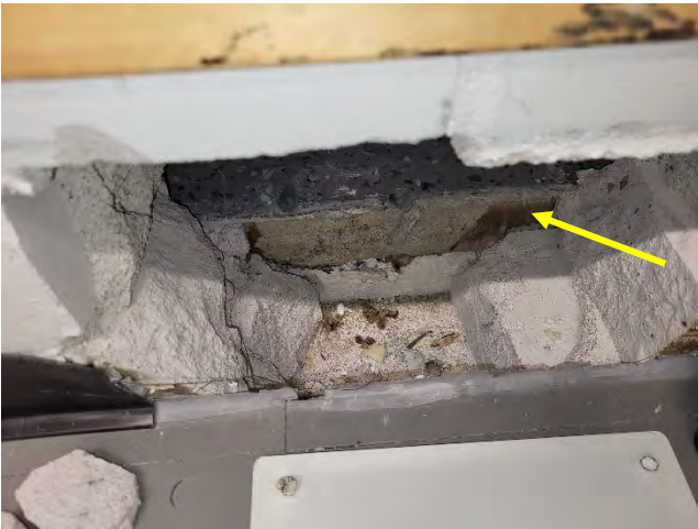
Kuva 37. Rakenneavaus RA-VS1. Muuraus lähtee alalaatan päältä. Muurauksen ja pintabetonilaatan välissä on valupaperia. Paperista otettiin materiaalinäyte M22 mikrobianalyysia varten, jossa todettiin poikkeavaa mikrobikasvua.
