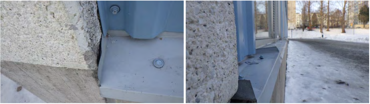
Kuva 66 a-b. a) Paikoin rakoja pellityksen ja ulkoseinän välissä. b) Pellitykset paikoin vaurioituneet.
