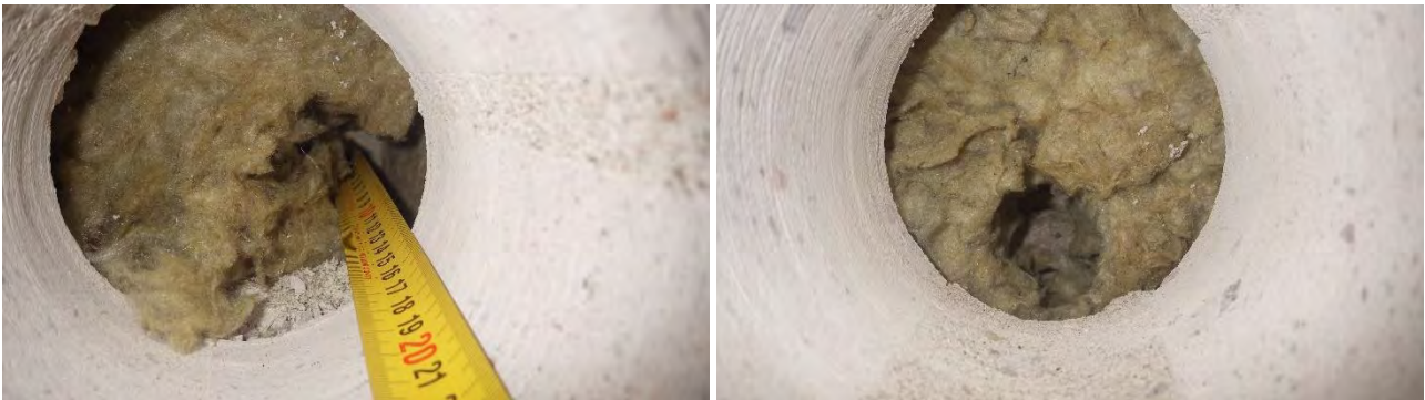
Kuvat 33 a-b. a) Rakenneavaus RA-MVS1 tilassa 131C. Perusmuurin sisäpinnalla ei ole vedeneristettä. Avauksesta havaittiin mikrobiperäistä hajua. b) Rakenneavaus RA-MVS2 lämmönjakohuoneessa 106Aa. Perusmuurin sisäpinnalla ei ole vedeneristettä.
