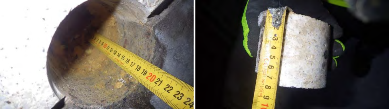
Kuvat 29 a-b. a) Kuva rakenneavauksesta RA-US8 ulkoseinän ja sokkelirakenteen liitoskoh- taan. b) Sokkelin ulkokuoren paksuus on ulkokautta mitattuna n. 65 mm ja ulkoseinän ulko- kuoren paksuus n. 75 mm.
