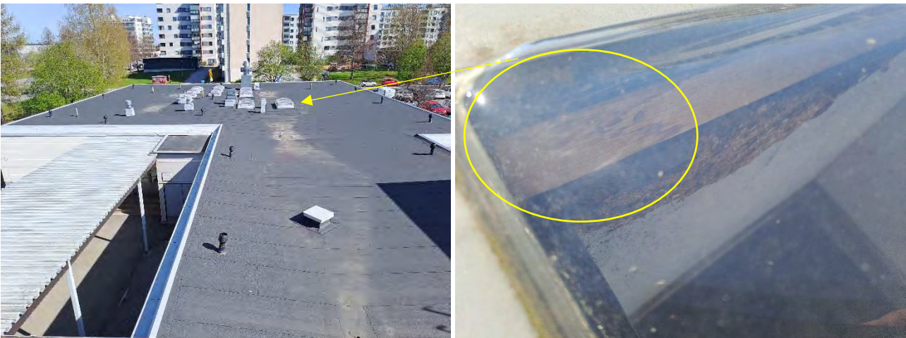
Kuvat 60 a-b. a) Yleiskuva B-osan vesikatosta. Etualalla IV-tarkastusluukku, jonka kautta yläpohjarakennetta ei voinut kunnolla tarkastaa. Takaosalla kuvassa kattovalokupuja. b) Useissa kattovalokupujen kotelorakenteissa on kosteusjälkiä.
