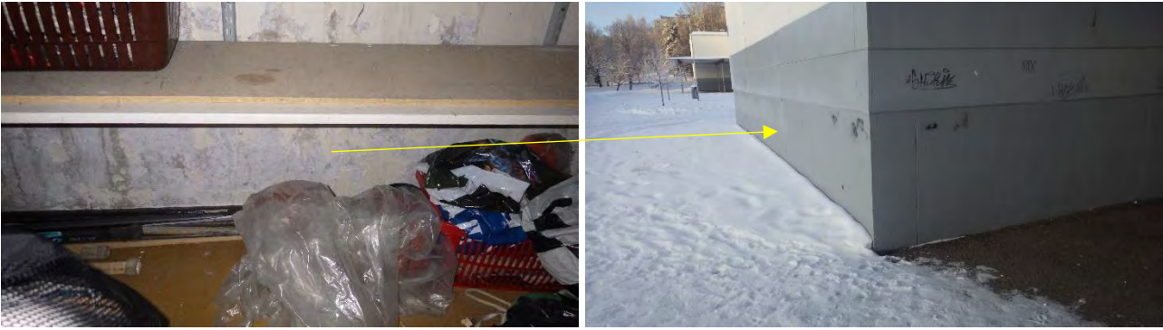
Kuva 31 a-b. a) Porrashuoneen 133D päätyseinässä kalkkihärmää. Pintakosteusilmmaisimella ei havaittu poikkeavaa kosteutta. b) Kuva ko. kohdasta ulkoa.
