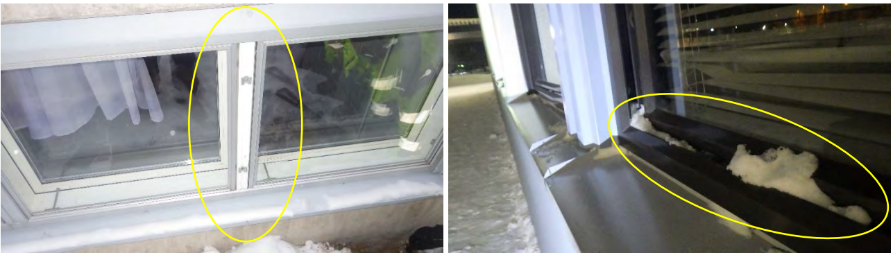
Kuva 67 a-b. a) E-osan länsisivulla ikkunasta puuttuu peltilista, ja lumi pääsee ikkunarakenteiden sisälle. b) Tilan 132C uloimmat ikkunalasit auki, lunta sataa ikkunarakenteen sisälle.
