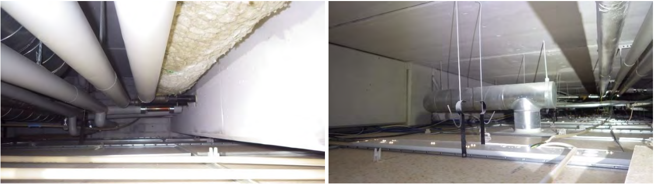
Kuvat 46 a-b. a) Tilan 103Ea alakatossa pinnoittamatonta mineraalivillaa. b) Käytävän 102E alakattotilassa runsaasti rakennuspölyä.
