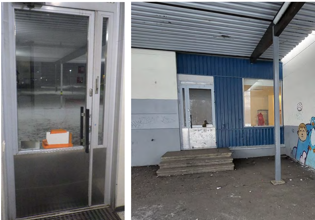
Kuva 69 a-b. a) Yleiskuvaa rakennuksen lasi-metallirakenteisista ulko-ovista. b) Ulko-ovet esteettisesti huonokuntoisia. Tuulikaapin/käytävän lasitukset todennäköisesti alkuperäisiä.
