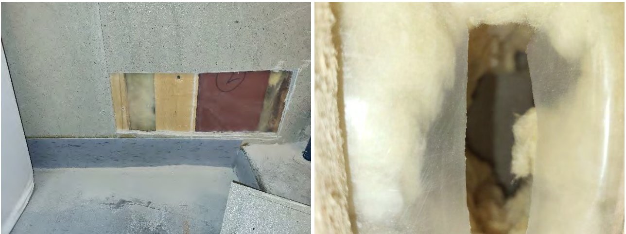
Kuva 28 a-b. a) Kuva IV-konehuoneen ulkoseinän rakenneavauksesta RA-US17. Ulkoseinä- kenteen sisällä kulkevat kattorakenteita kannatteleva teräspilari. b) Mineraalivillaeris- teen paksuus n. 160 mm.
