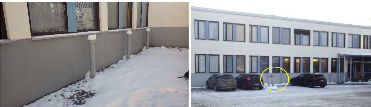
Kuvat 8 a-b. a) Rakennuksen länsipuolella olevat tuuletusputket menevät suoraan lämmönjakohuoneeseen. b) Rakennuksen pohjoispuolella tuuletusputket menevät teknisiin tiloihin sekä väestönsuojaan.
