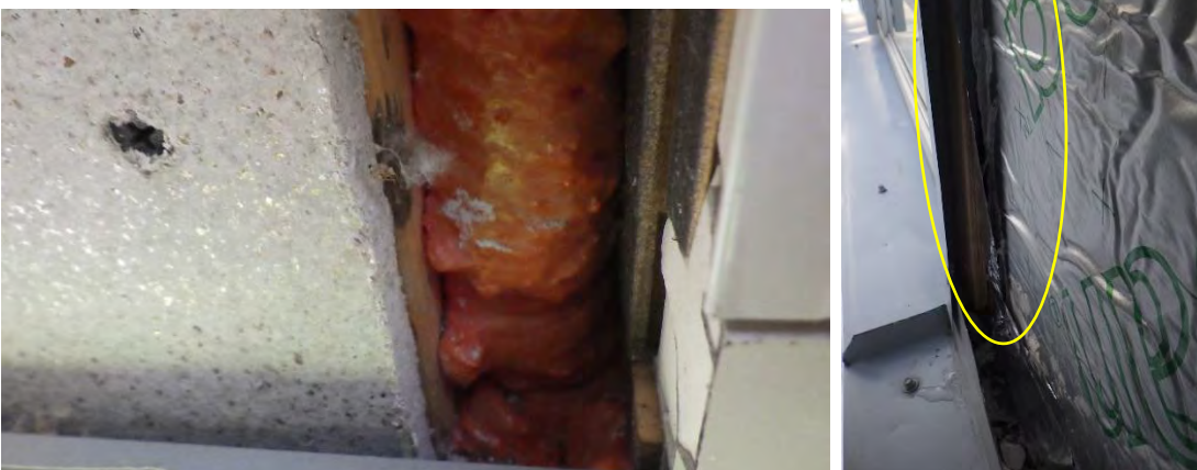
Kuva 68 a-b. a) Tilan 126A ikkunavälin tiivistyksessä puutteita. Ulkopinnassa kuitusementtilevy ja sen takana mineraalivilla. b) Tilan 124E kohdalla uretaanilevy ei ole sivuilta tiivis.
