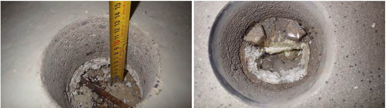
Kuvat 11 a-b. a) Rakenneavaus RA-AP1 lämmönjakuhuoneessa 106Aa. b) Rakenneavaus RA-AP3 WC-tilassa 121Aa.
