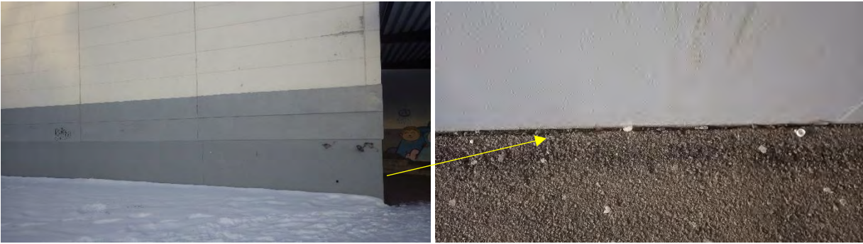
Kuvat 6 a-c. a) D-osan päädyssä alimpien kevytbetonilankkujen päälle on asennettu peltinen suoja suojaamaan pintarakennetta mekaanisilta iskuilta. b) Sokkelin ja asfalttoinnin välissä on paikoin suuriakin rakoja.
