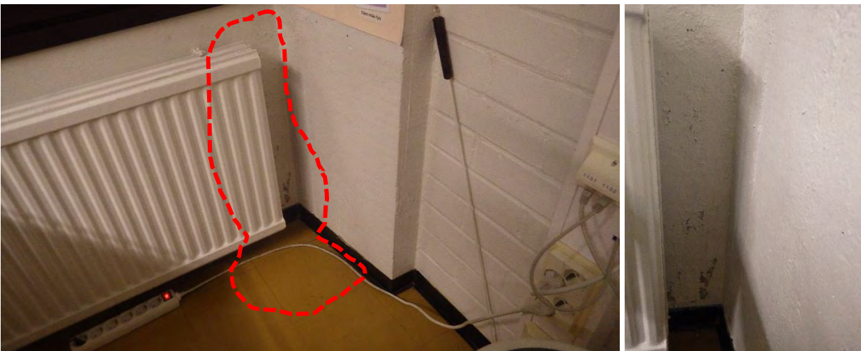
Kuva 30 a-b. a) Kohonneita pintakosteusilmaisimen arvoja tilan 131C ulkoseinän ala- osassa. b) Maalipinta on hilseillyt irti kosteuden seurauksena.
