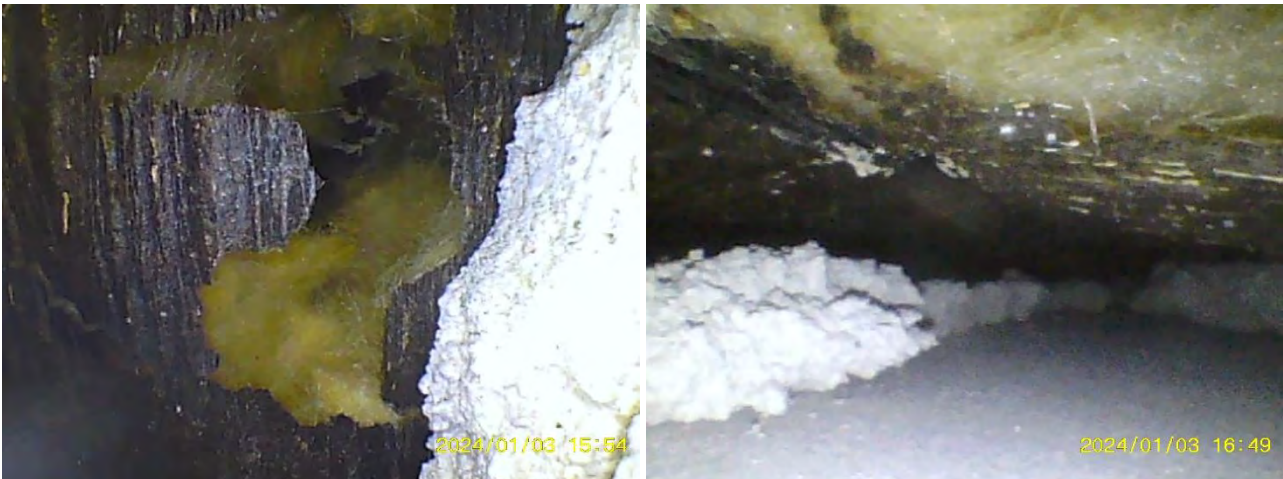
Kuvat 38 a-b. a) Rakenneavauksesta RA-VS2 havaittiin väliseinärakenteessa olevan alkupe- räinäinen mineraalivilla paikoillaan. Villasta otettiin materiaalinäyte M23, jossa ei todettu poikkeavaa mikrobikasvua. b) Kuorimuurauksen ja villan välissä pieni tuuletusväli.
