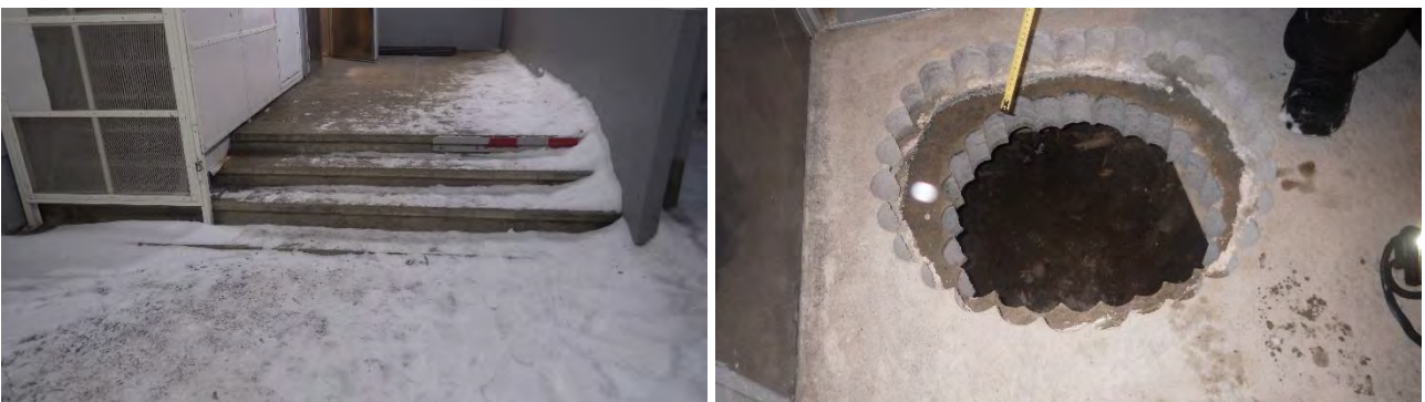
Kuva 76 a-b. a) Yleiskuva tuulikaapin edustalta ulkoportailta. b) Rakenneavaus tuulikaapin 201A lattiaan.
