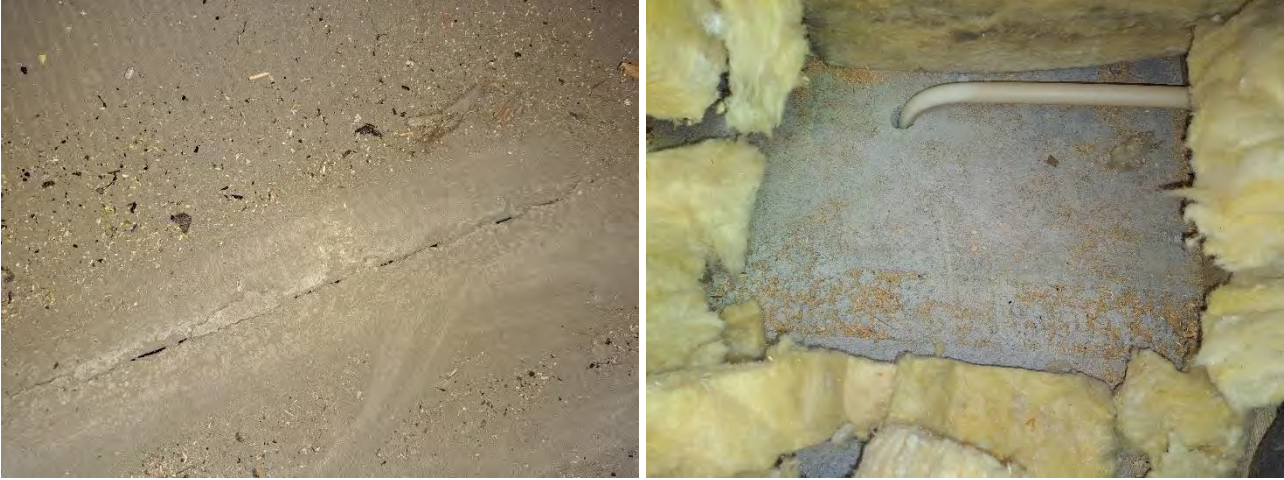
Kuvat 59 a-b. a) B-osalla kevytbetonilankkujen saumat yläpuolelta haljennut. b) E-osalla avoin sähköputken läpivienti. Ontelosaumojen kohdalla ei ole bitumikermikaistaa.
