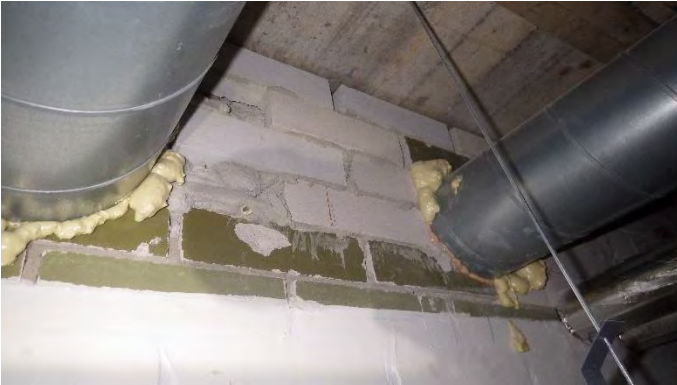
Kuva 40. Alakatoista havaittiin epätiiviyiskohtia käytävien ja luokkahuoneiden välillä. Osa läpivienneistä on tiivistetty polyuretaanivaahdotuksella. Tiiliseinien yläosia ei ole käsitelty (maalauksella tai muulla pölysuojauksella). Kuva D-osan käytävältä.
