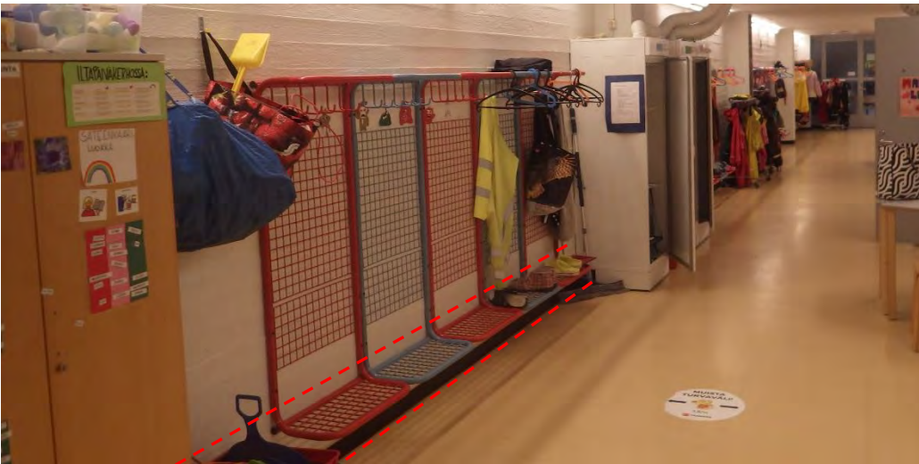
Kuva 17. A-osan käytävällä kohonneita pintakosteusilmaisimen arvoja alapohjassa ja väestönsuojan seinässä.
