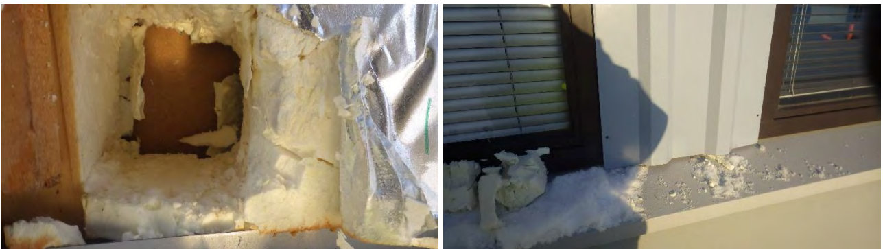
Kuva 62 a-b. a) Rakenneavaus RA-US10 tilan 119A ikkunoiden väliin. b) Peltiverhoilu ikkunoiden välissä.
