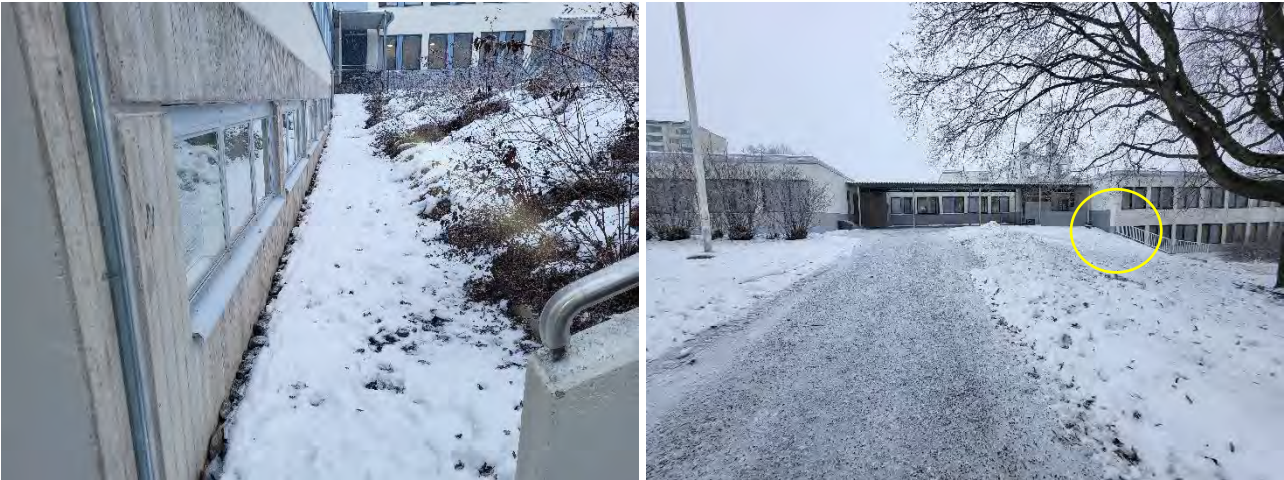
Kuvat 4 a-b. a) Maanpinta kaataa rakennusta kohden E-osan länsisivustalla. b) Maanpinta kaataa rakennusta kohden C-osan pohjoispäädyssä rakennuksen länsisivustalla.
