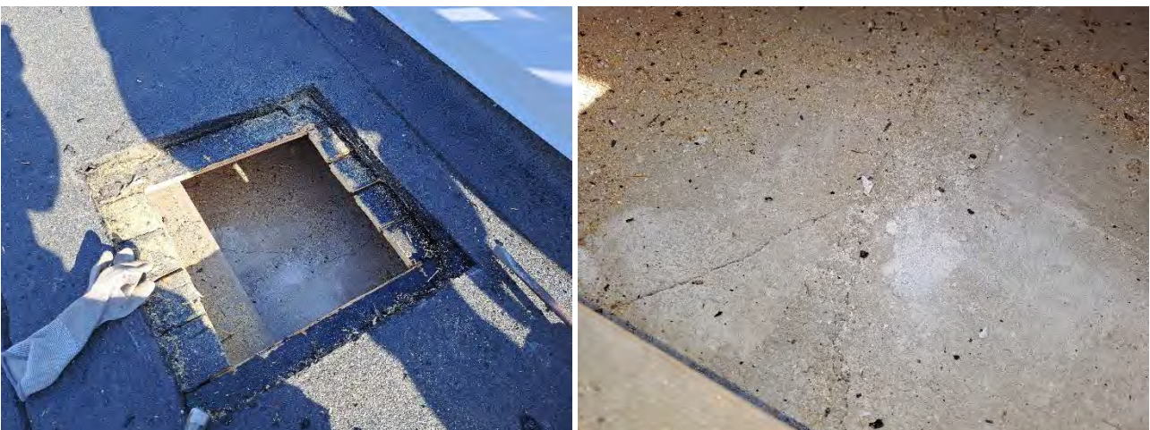
Kuvat 51 a-b. a) Yleiskuva rakenneavauksesta RA-YP8 rakennuksen B-osalla. b) Ko. rakenneavauksen kohdalla kevytbetonilankussa pinnan halkeilua ja kopoa.
