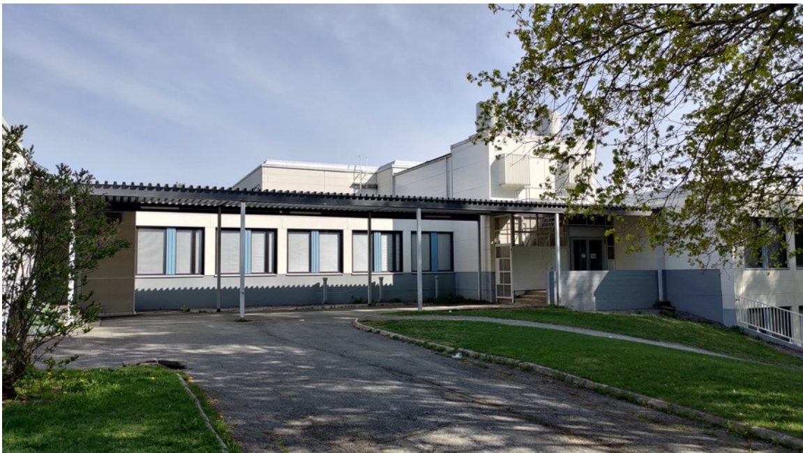
Kuva 2. Koulurakennus. Katot tasakattoisia ja sinne on sijoitettu ilmastointijärjestelmiä.
