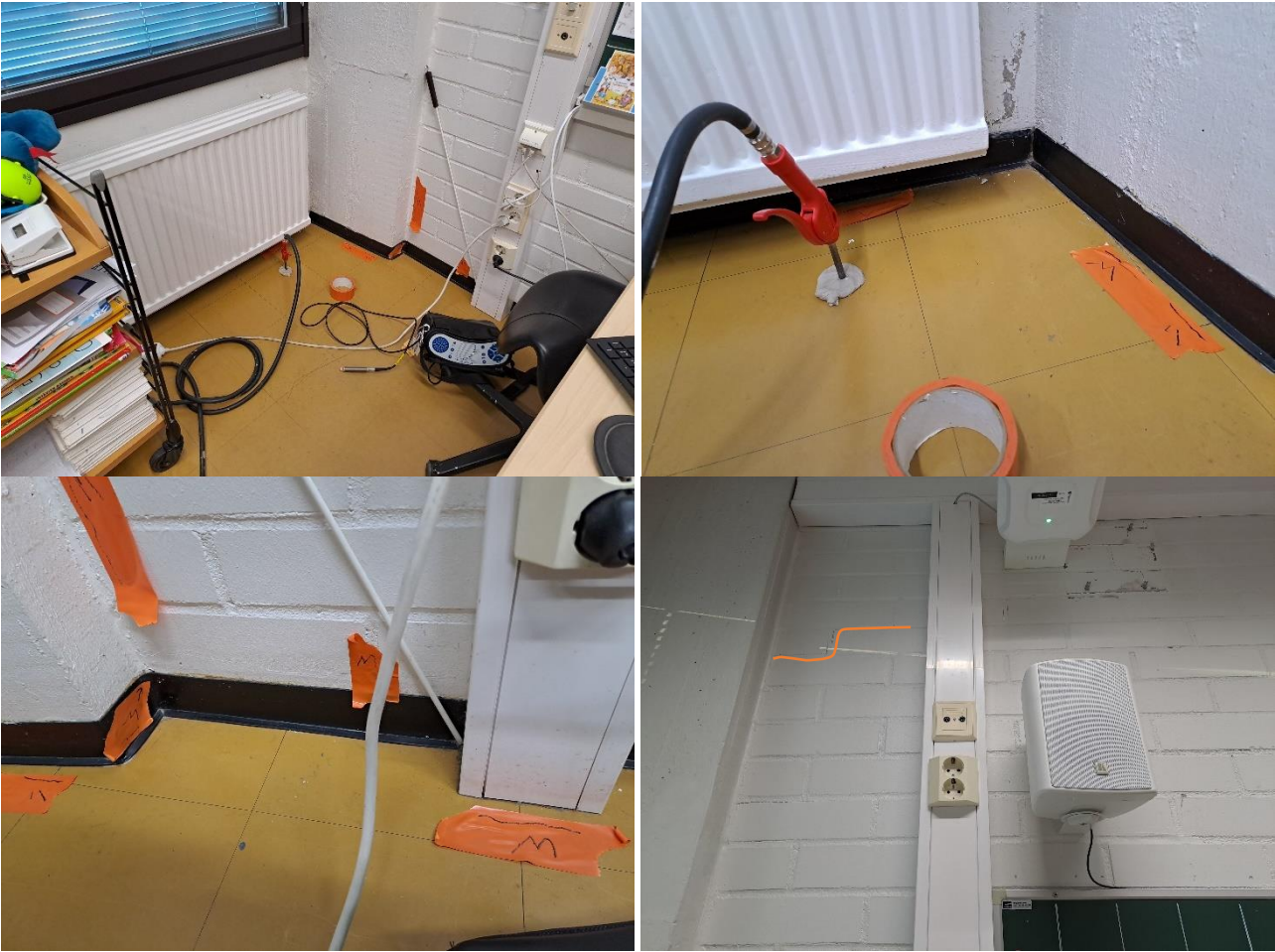
Kuvat 5 a-d. a) Yleiskuva merkkiaineen syöttökohdasta. b) Merkittävää ilmavuotoa ulkoseinäliittymästä ja pilarin juuresta. c) Merkittävää ilmavuotoa havaittiin maanvastaisen seinän pilari- ja alapohjaliittymästä sekä sähkökourun kohdalta. d) Maanvastaisen seinän kuorimuurissa on halkeama, josta ilmavuoto on mahdollinen.
