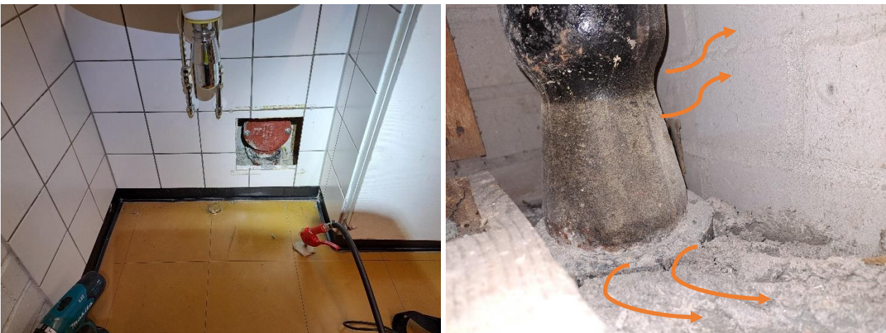
Kuvat 6 a-b. a) Luokkien vesipisteiden kohdalla on kuvan mukainen kotelorakenne. b) Tilan 131C kotelorakenteen sisällä on alapohjaläpivienni ja sieltä on yhteys maanvastaisen seinän eristetilaan. Sekä alapohjan läpiviennistä ja maanvastaisesta seinästä havaittiin ilmavuotoa.
