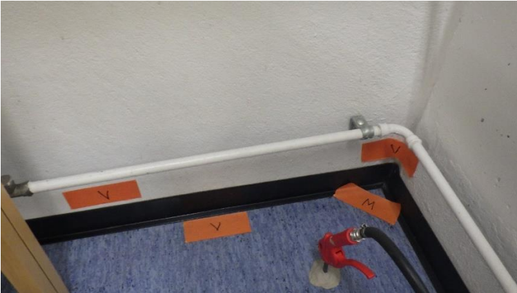
Kuva 13. Alapohja-ulkoseinäliittymästä todettiin vähäistä ilmavuotoa ja pilariliittymän kohdalta merkittävää ilmavuotoa.
