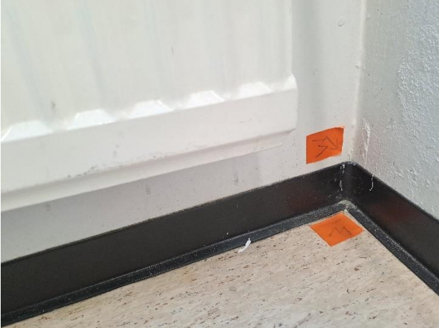
Kuvat 14 a-c. a) Yleiskuva tilan 219E kevytrakenteiseen ulkoseinään tehdystä merkkiainekokeesta. Lämpöpatteri on irronnut osin kannakkeistaan. b) Merkittävää ilmavuotoa ikkunaliittymistä ja patterikannakkeen kohdalta. c) Merkittävää ilmavuotoa ulkoseinä-välipohja-pilari-liittymästä.
