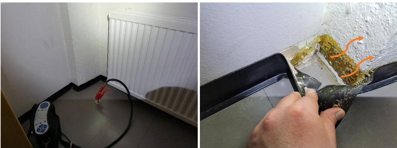
Kuvat 4 a-b. a) Yleiskuva merkkiaineen syöttökohdalta. b) Vähäistä ilmavuotoa muovilistan takaa pilariliittymästä. Pilariliittymää on tiivistetty edellisen kuvan mukaisella massalla.
