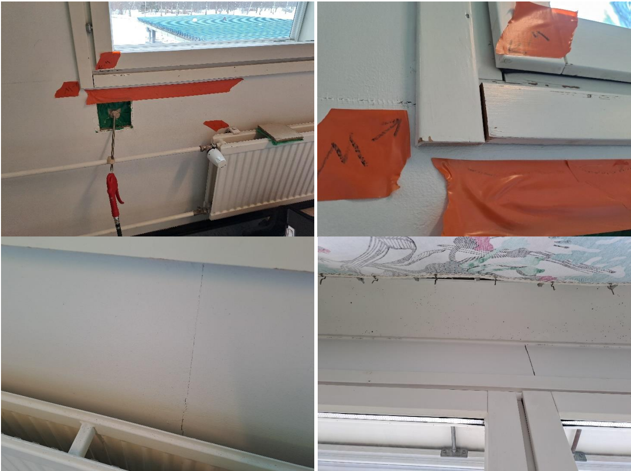
Kuvat 15 a-d. a) Yleiskuva käytävään 203E tehdyistä merkkiainekokeista. b) Merkittävää ilmavuotoa ikkunaliittymästä ja patterikannakkeen kohdalta. c) Levyseinän saumakohdissa on halkeamia. d) Levyseinässä ja yläpohjaliittymässä on epätiiviyiskohtia.
