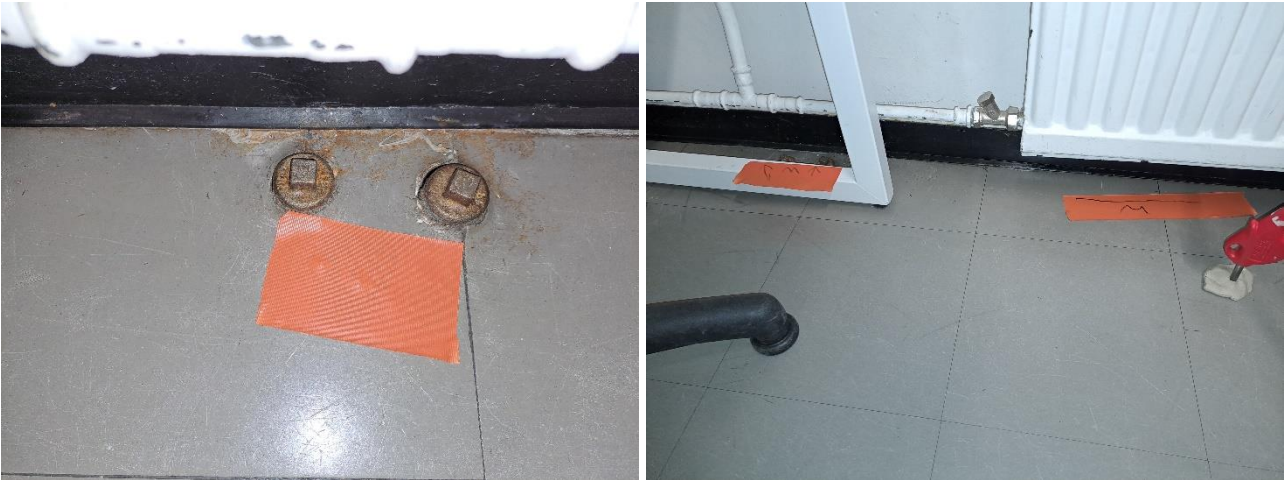
Kuvat 7 a-b. a) Merkittävää ilmavuotoa vanhojen patteriputkien läpiviennin kohdalta. b) Merkittävää ilmavuotoa alapohja-ulkoseinä-liittymästä ja vanhojen patteriputkien läpiviennin kohdalta.
