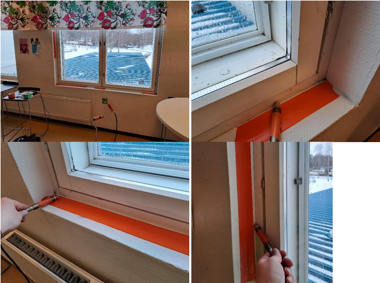
Kuvat 11 a-d. a) Yleiskuva aulan 230A merkkiainekokeista idän puoleiselta seinustalta. b-d) Merkittävää ilmavuotoa todettiin ikkunaliittymistä.
