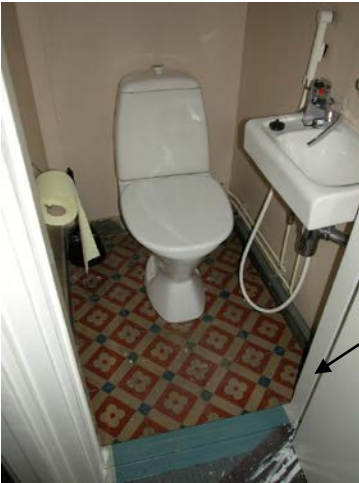
119 WC, vanha lattiaaatoitus
