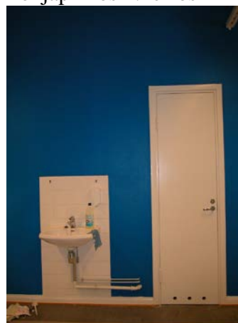
Neuvotteluhuone, itäseinän vesipiste
