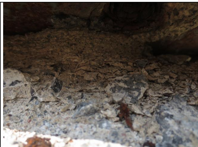
Kuva 5: Betonin pakkasrapautumaa kantavassa laatussa.
