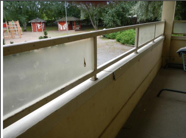
Kuva 1: Terassiparvekkeen käsijohteen vaurioita
