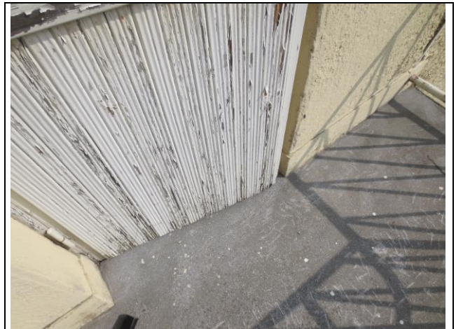
Kuva 4: Parvekeovet ja -ikkunat ovat kuluneet. Maalit hilseilevät irti.
