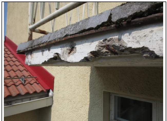
Kuva 6: Parvekelaatoissa on näkyvissä teräskorroosiovaurioita.
