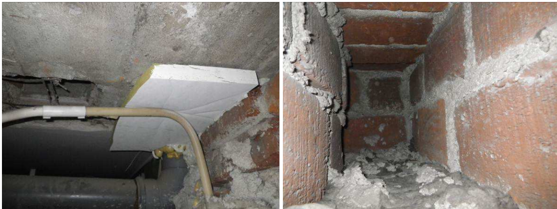
Kuvat 13 a ja b. 2.krs molempien WC-tilojen alaslasketun katon takaa löytyi hormiläpivientejä, jotka ovat yhteydessä rakennuksen keskellä sijaitsevaan kokoojakanavistoon. Hormeja oli tukittu puutteellisesti akustolevyillä (vas. kuva).
