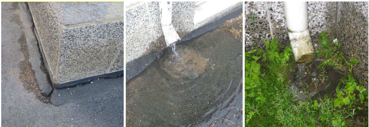
Kuva 3 a, b ja c. Rakennuksen päädyssä on havaittavissa patolevy ja holkka-asfaltti (a). Leikkihän puolella on sadevesiviemäri, kaivot ovat kuitenkin tukossa hiekasta (b). Etupihan puolella sadevesi imeytetään suoraan maahan (c).
