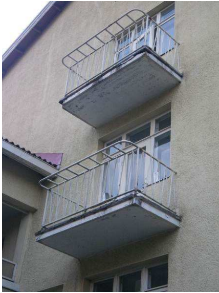
Kuva 6. Rakennuksen pohjoispäädyn parvekkeet ovat huonossa kunnossa ja parvekelaatan reunasta on irtoillut betonia.
