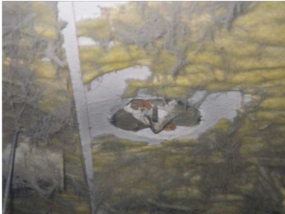
Kuva 12. 2. kerroksen WC:n kohdalla yläpohjarakenteen alapintaan on jätetty soiroja vanhasta akustovillasta. Ilmavirta voi irrottaa vanhoista eristeistä villakuituja sisäilmaan.
