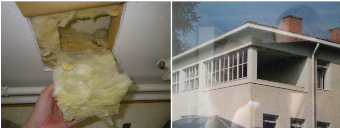
Kuva 9. 2. kerroksen laajennusosan kevytrakenteiseen ulkoseinään tehtiin rakenneavaus (a). Kohdalla on ennen sijainnut kylmä nukutusparveke (b).
