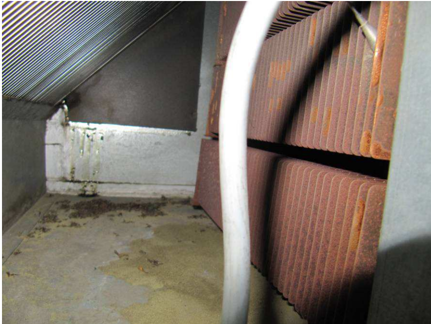
Kuva 17. 2. kerroksen ilmanvaihtokoneen tuloilmakammio, vasemmalla lämmöntalteenottokenno. Tuloilmakoneen ruosteenpunainen sähköpatteri oikealla.
