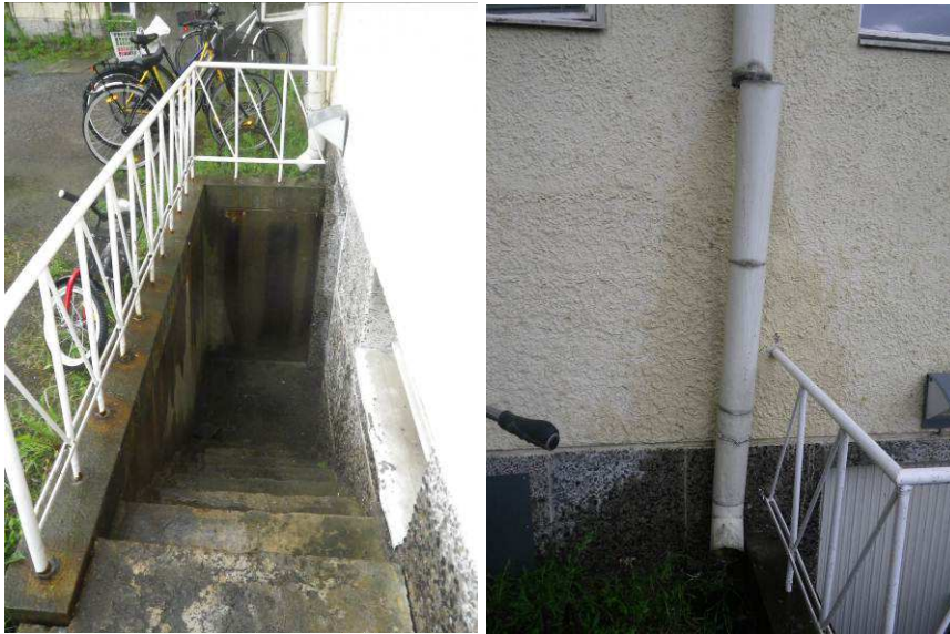
Kuvat 4 a ja b. Sadevettä ja lunta pääsee kertymään kellarinportaisiin (a). Yksi sadevesiränni on katkennut ja sadevesi pääsee rasittamaan rasituksen julkisivua (b). Rakennuksen sisältä ei havaittu kuitenkaan kohonneita pintakosteuksia tai muita merkkejä kosteusrasituksesta.
