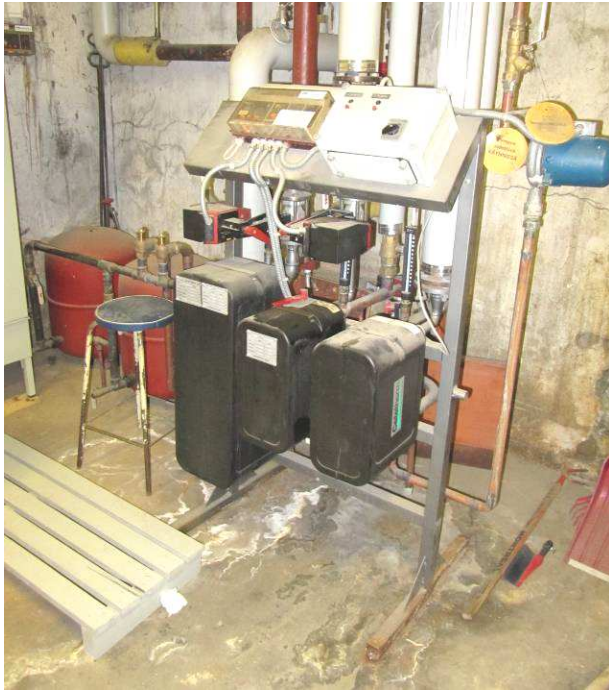
Kuva 20. Nekalan päiväkodin lämmönjakokeskus.
