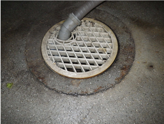
Kuva 15. Päiväkodin keittiön lattiakaivon reunalla on havaittavissa halkeilua ja kohonneita pintakosteuksia.
