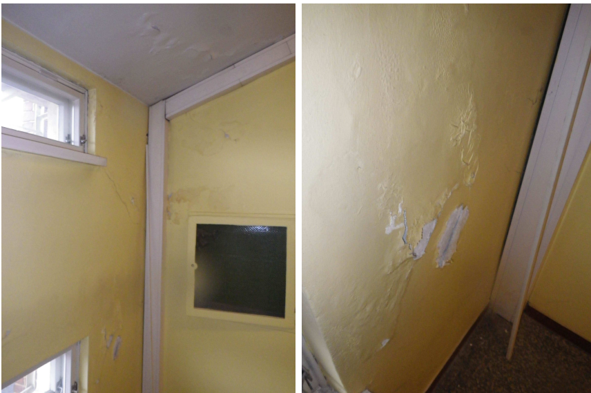
Kuvat 16 a ja b. Porraskäytävän seinässä on ylimmässä kerroksessa merkkejä vanhoista kosteusvaurioista. Seinästä ei havaittu kohonneita pintakosteuksia.
