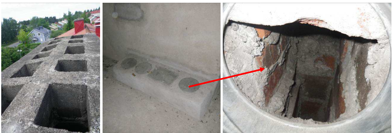
Kuvat 14 a, b ja c. Vanhan painovoimaisen ilmanvaihtojärjestelmän kokoojakanavisto on avoinna yläpäästään (a) ja kanavistosta on yhteys myös yläpohjan ullakkotilaan. Ullakkotilan luukut on suljettu pelleillä, joiden tiiviys on puutteellinen (b).
