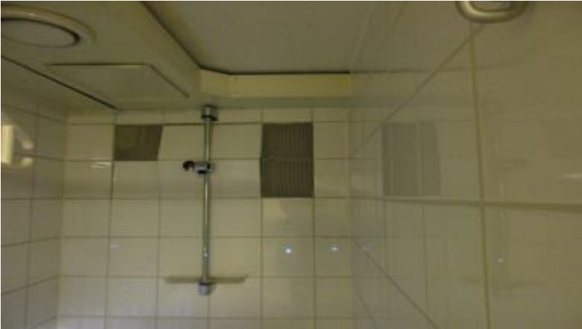
Kuva 4. Suihkuhuoneen laatoituksessa saattaa olla asbestia
