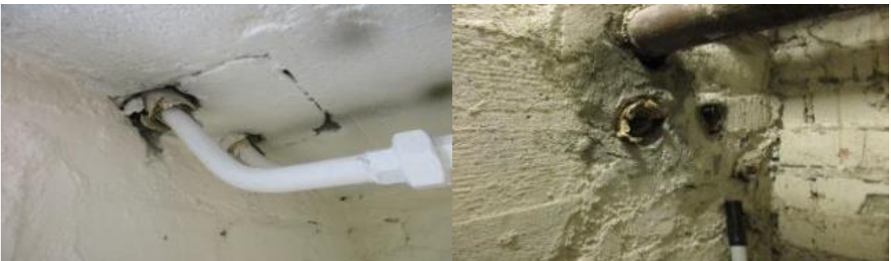
Kuva 3. Vanhat putkieristeet voivat sisältää asbestia
