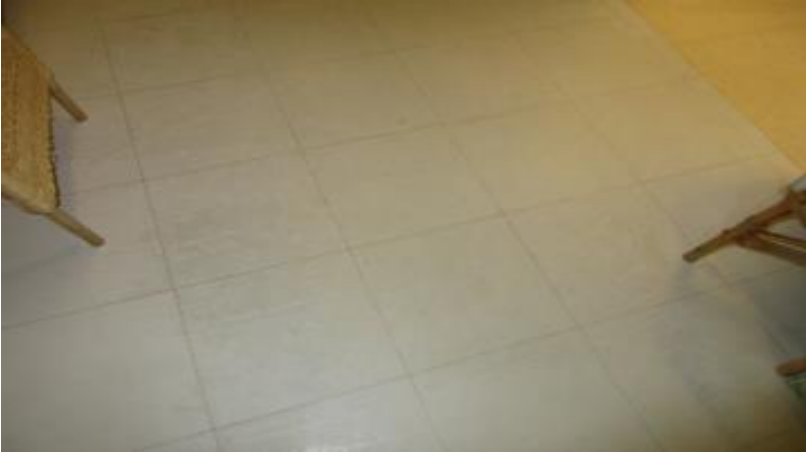
Kuva 1. Käytävien ja aulan vinyylilaatat voivat sisältää asbestia
