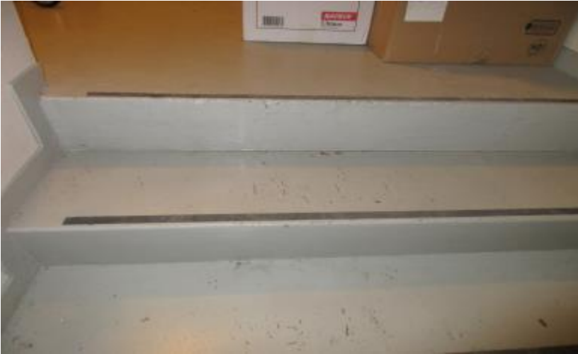
kuva 5. Kellarikerroksen maali saattaa sisältää raskasmetalleja
