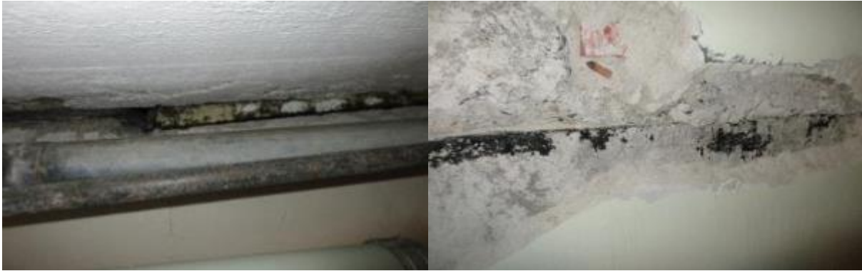
kuva 7. Kellarin seinissä on pikisively joka voi sisältää PAH-yhdisteitä
