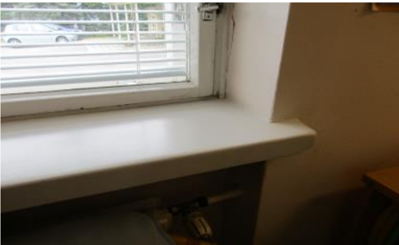
Kuva 6. Huoneiden ikkunoiden smyygi saattavat sisältää lyijyä
