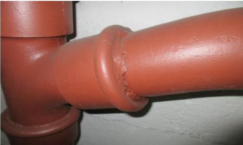
Kuva 2. Valurautaisten viemäriputkien liitoksissa voi olla lyijyä
