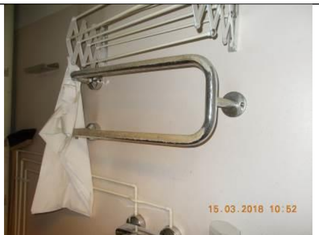
Siivouskomeron lämmityspatterin liitoksissa on havaittavissa vuotojälkiä
