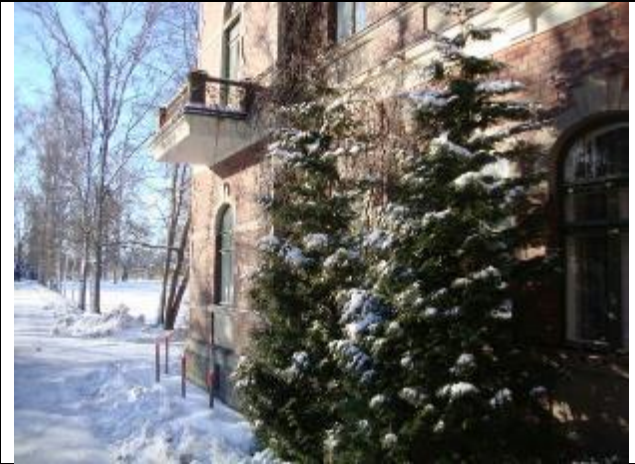
Puiden oksat ovat kiinni julkisivussa
