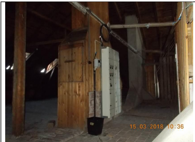
Ullakolle on sijoitettu kuusi ilmanvaihdon poistoilmapuhallinta
