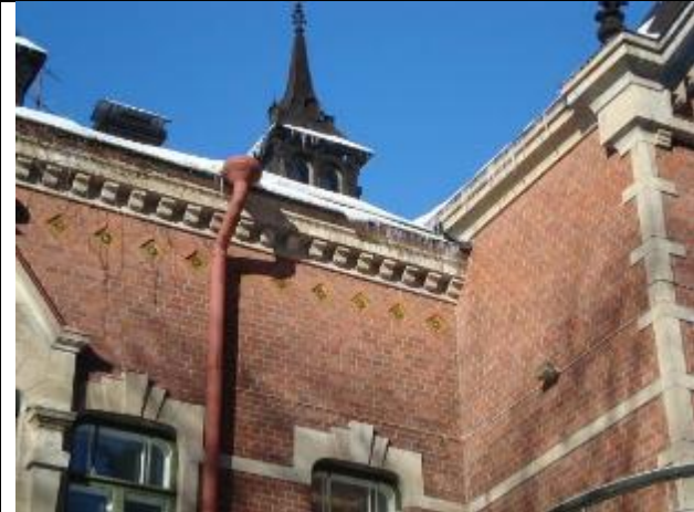
Syöksytörvessa on suppilon alapuolella vuotoa julkisivulle
