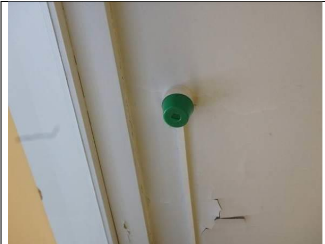
Ikääntynyt hehkulampputyypinen poistumistievalaisin, joka oli pimeänä tarkastushetkellä
