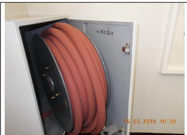
Alkusammutusjärjestelmä tulee tarkastaa säännöllisesti
