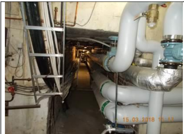
Kuvassa energiatunneli, jota pitkin lämmitysputkien lisäksi siirtyy myös vesi ja sähkö
