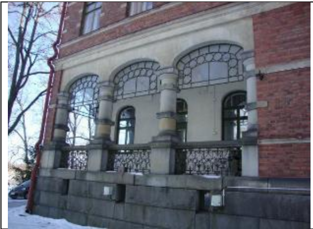
Luonnonkivisokkeli on paikoin sammaloitunut
