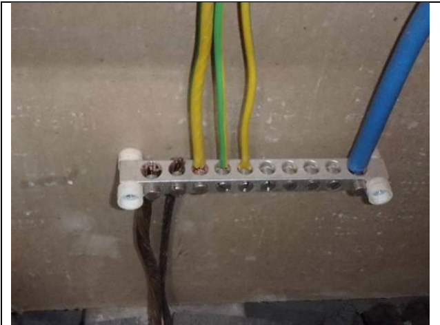
Pääpotentiaalintasauskisko on asennettu 1991 saneerauksessa
