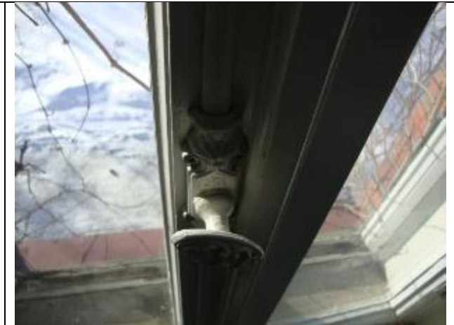
Ikkunoiden vanhat heloitukset ovat vielä pääosin toimivia
