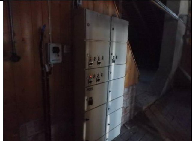
Ullakolla sijaitseva ilmastoinnin keskus
