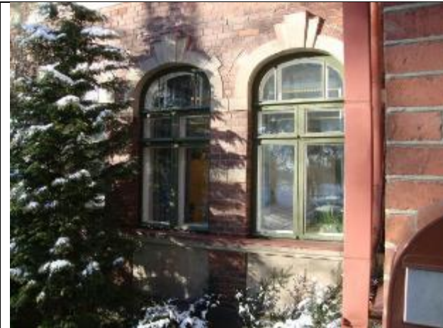
Itäisivun monimuotoisia, huonokuntoisia ikkunoita
