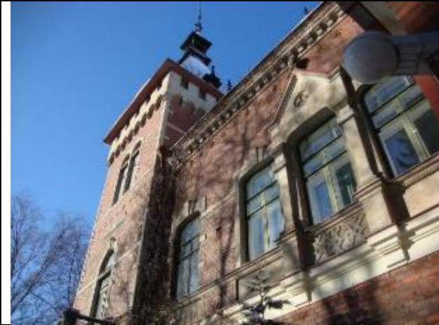
Rakennuksen seinustalla ja seinällä kasvaa köynnöskasvi
