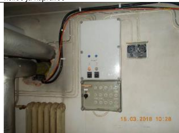
Teknisissä tiloissa on läpivientejä paikkaamatta
