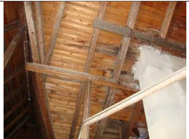
Piipun läpiviennissä on havaittavissa todennäköisesti vanhoja vuotojälkiä
