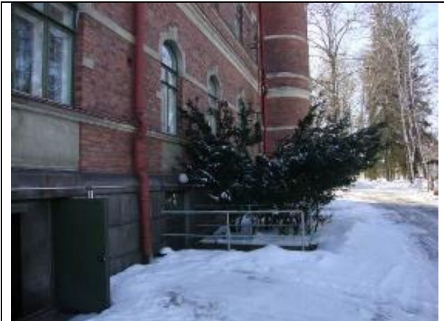
Maanpinta on tasaista. Sade- ja sulamisvedet jäävät kivijalan vierustalle
