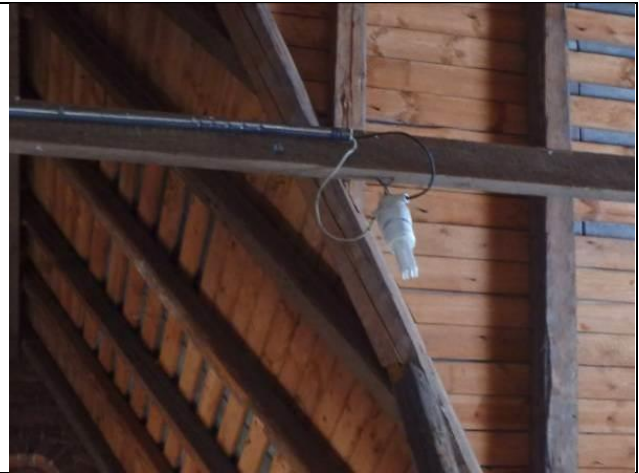
Samoin tässä on asennus sähköturvallisuusmääräysten vastainen
