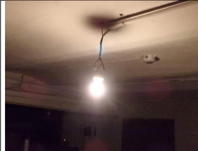
Käyttöeristetyt johtimet ovat kosketeltavissa sähköturvallisuusmääräysten vastaisesti
