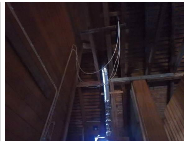
Ullakolla kiinnittämättömiä kaapeleita
