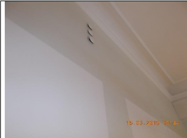
Painovoimaisen ilmanvaihdon säädettäviä poistil-maventtiilejä
