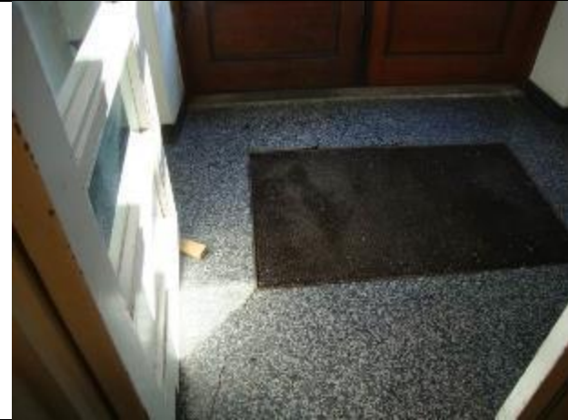
Pääsisäänkäynnin tuulikaapin lattian pinnoite halkeilee ja kupruilee
