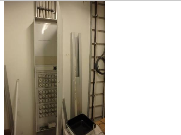
Tulppasulakkeilla varustettu ryhmäkeskus on tyydyttävässä kunnossa
