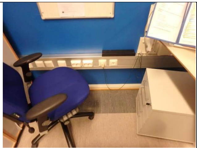
Toimistotiloissa on käytetty 1-luokan suojamaadoitettuja pistorasioita
