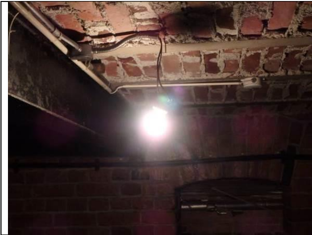
Käyttöeristetyt johtimet ovat kosketeltavissa sähköturvallisuusmääräysten vastaisesti
