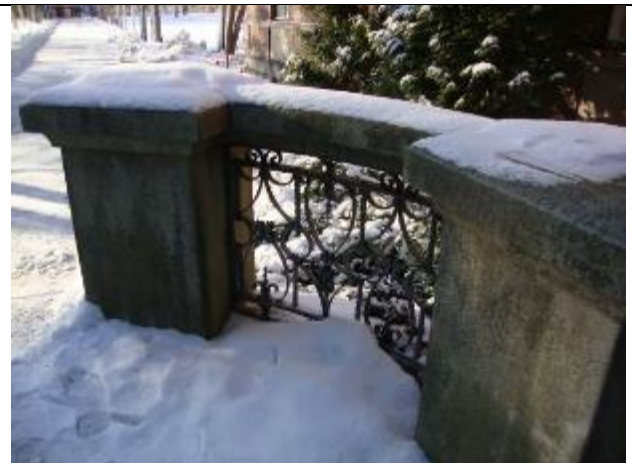
Pääsisäänkäynnin kaiteiden metalliosat kaipaavat huoltomaalauksia
