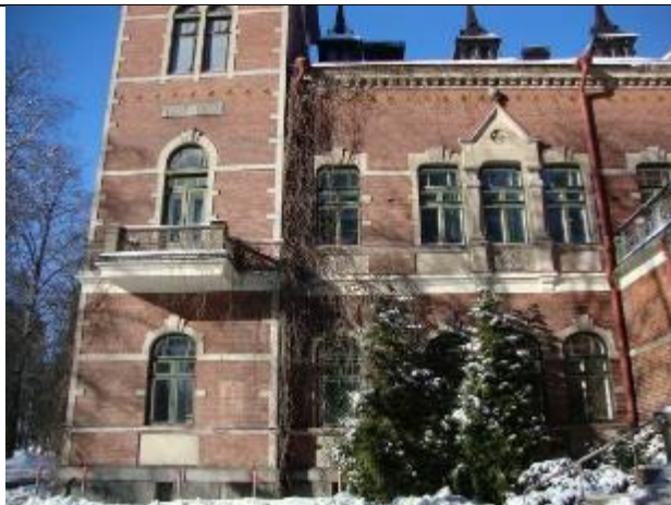
Köynnöskasvi ja rakennuksessa kiinni olevat puisten oksat rapauttavat tiilimuurausta
