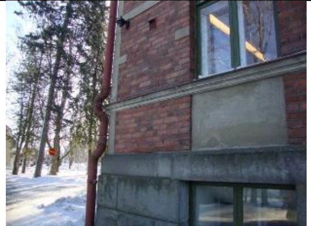
Syöksytorvet ovat ruosteessa ja kaipaavat kunnostusta
