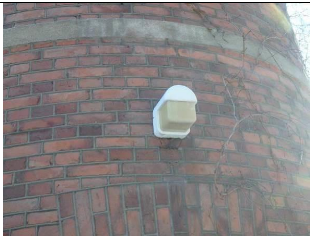
Seinävalaisimen kupu on kellastunut
