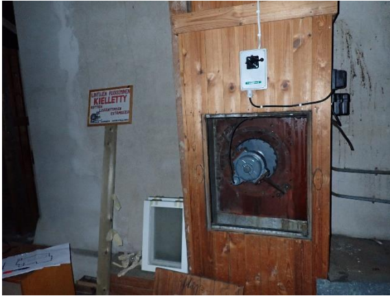
Kuva 7 PK1 on keskipakoispuhallin
