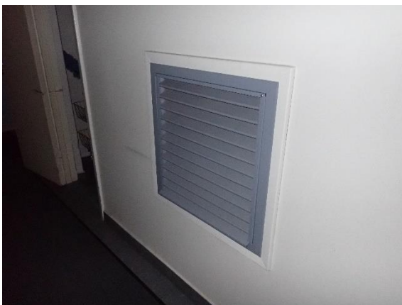
Kuva 23 Siirtoilmasäleikkö eteisessä 124. Kanava on yhdistetty alapuolella sijaitsevaan lämmönjakohuoneeseen
