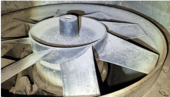
Kuva 9 PK2 aksiaalipuhaltimen siipipyörät ovat likaantuneet.
