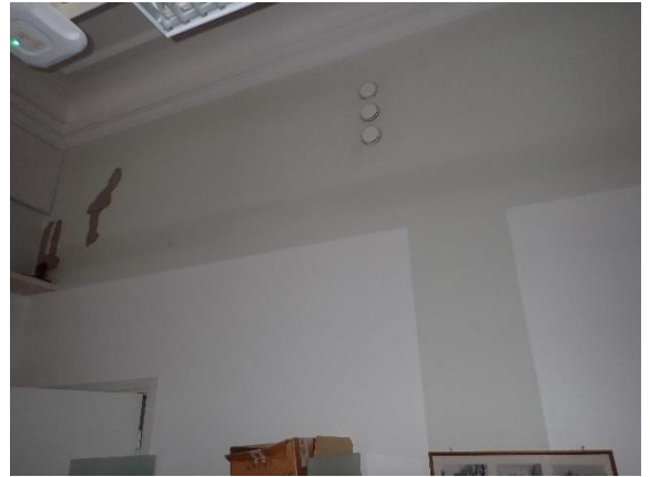
Kuva 22 Poistoilmapuhaltimeen yhdistetyt lautasventtiilit toimistohuoneessa 221.
