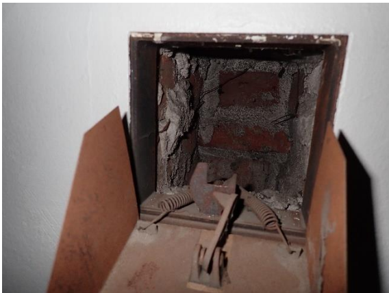
Kuva 15 Ulkoseinän kippiventtiili on yhdistetty tiilihormiin.
