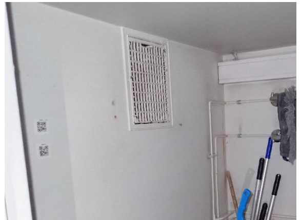
Kuva 6 Alkuperäinen poistoilmaventtiili 1. kerroksen siivouskomerossa.
