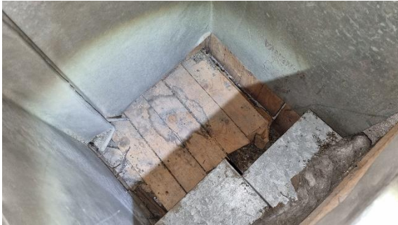
Kuva 13 Peltirakenteiset kanavistot yhdistyvät lautarakenteisiin sekä tiilihormeihin, ja ovat heikosti puhdistettavissa.
