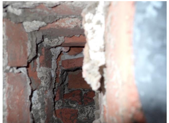
Kuva 16 Painovoimaisen ilmanvaihdon poistoilmahormit toimivat osittain korvausilma-riteinä, joiden kautta ilmaa virtaa rakennukseen.
