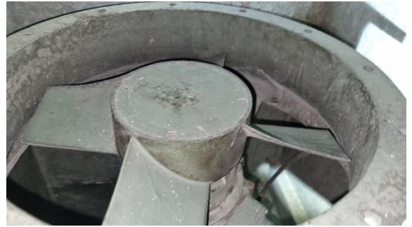
Kuva 10 PK3 aksiaalipuhaltimen siipipyörät ovat likaantuneet..
