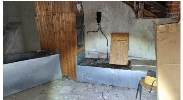
Kuva 12 PK4 kotelointi ja kanavistoa ullakolla.
