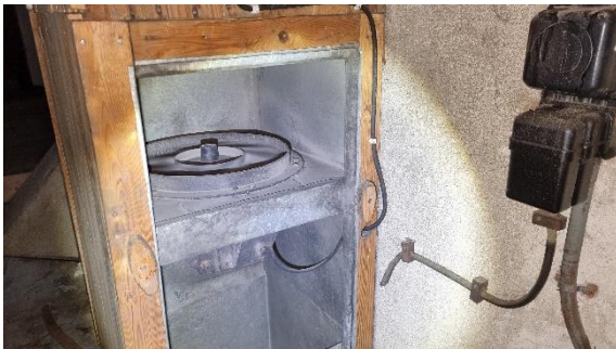
Kuva 11 PK4 aksiaalipuhaltimen siipipyörät ovat likaantuneet..
