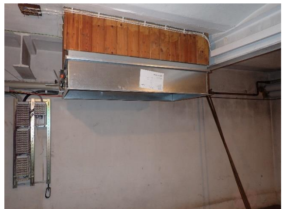
Kuva 24 Lämmönjakohuoneessa sijaitseva siirtoilmakanavan pää. Kanava on suljettu sälepelleillä.
