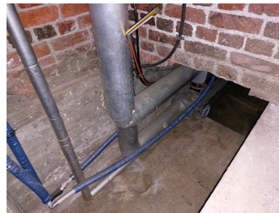
Puutteellisesti kannakoidut lämpimänkäyttöveden syöttö- ja kiertovesijohdot
