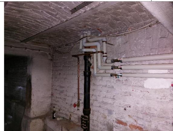
1991 uusittuja vesijohtoja sekä alkuperäinvalurautaviemäri rakennuksen kellaritiloissa
