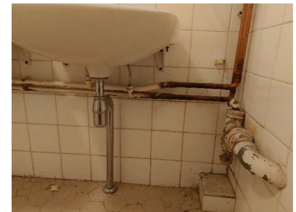
Kellaritilan pesuhuoneen ennen vuotta 1991 asennettujen ja 1991 uusitun vesijohdon liitos.
