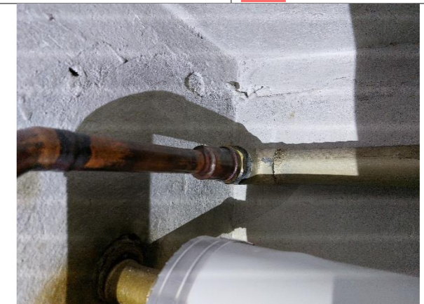
Ennen vuotta 1991 asennettuja vesijohtoja
