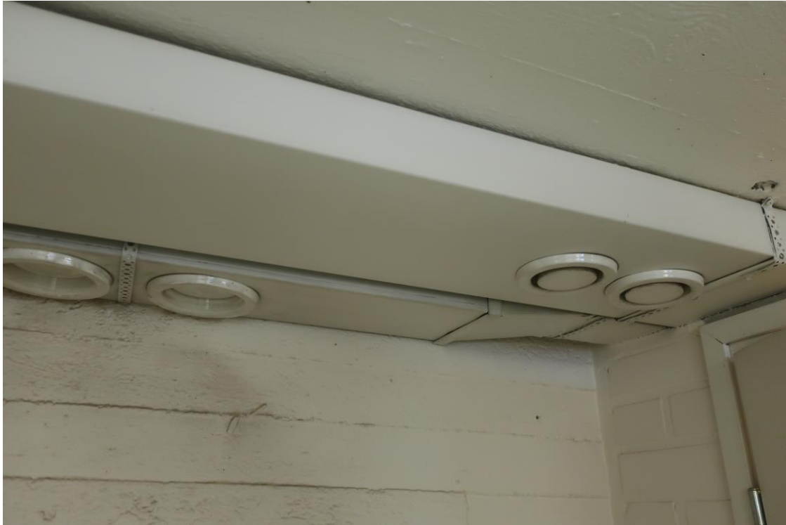
Kuva 9. Peltisten kantikanavien liitosten sisällä saattaa olla asbestipitoinen tiivistenauha.
