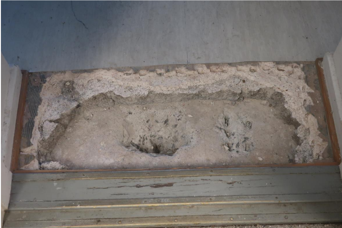
Kuva 14. Henkilökunnan ruokailutilan lattian muovimaton ja tasoitteiden alla oli asbestipitoista massaa. Ko. massaa saattaa olla myös muiden tilojen lattiarakenteissa.
