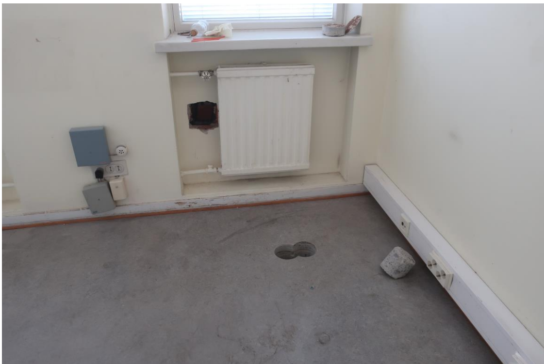
Kuva 13. Tilan 133 lattiapinnoite sisältää asbestia. Samaa lattiainnointia on käytetty myös muissa tiloissa ja komeroissa.
