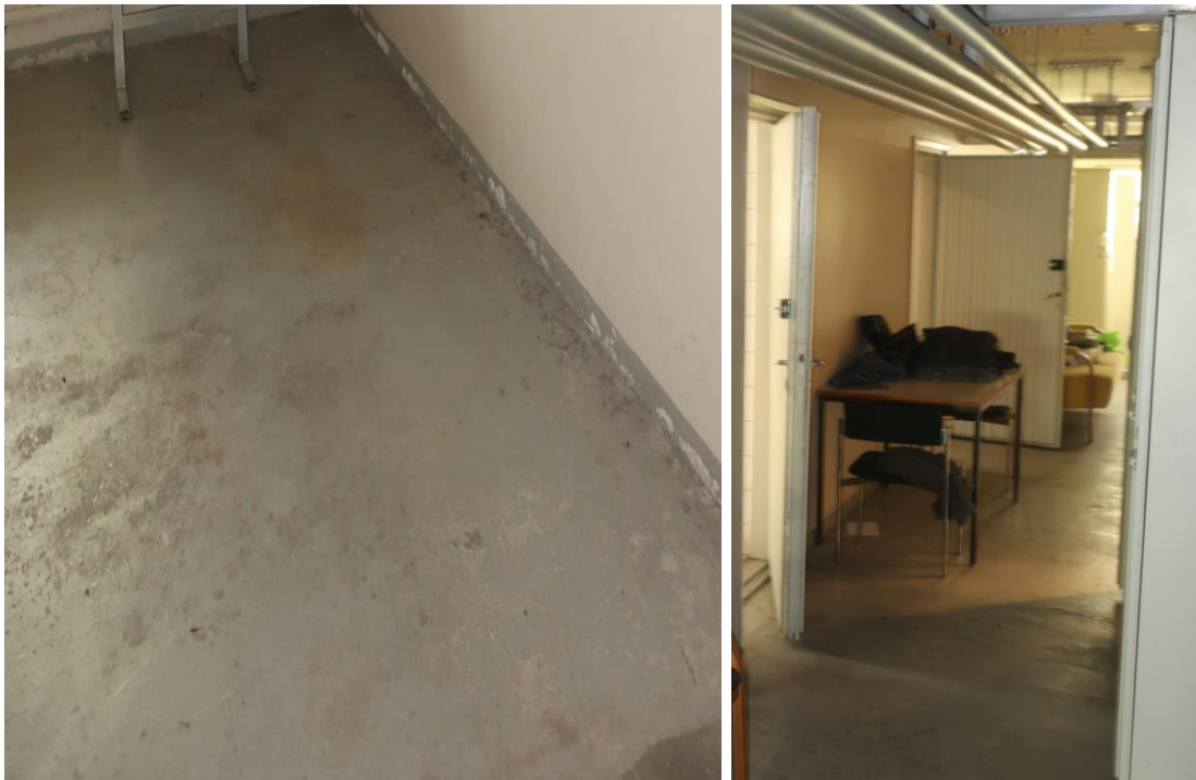
Kuvat 4 ja 5. Kellarikerroksen maalattut lattia sisältävät tutkitun näytteen mukaan asbestia. Tarvittaessa maalattujen lattioiden asbestipitoisuudet tutkitaan tilakohtaisesti.
