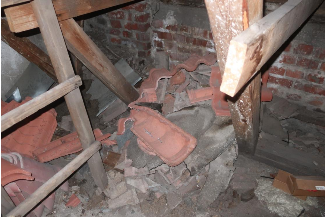
Kuva 19. Asuntosiiiven ullakon jätekasassa olevat bitumihuovan palat sisältävät asbestia. Jätekaa tulee hävittää asbestityönä ja asbestijätteenä.
