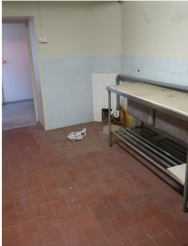
Kuva 6. Vanhojen seinäkaakelien kiinnityslaasti sisältää tutkitun näytteen mukaan asbestia. Lattia- klinkkereiden kiinnitys ja saumalaastit eivät sisällä asbestia.
