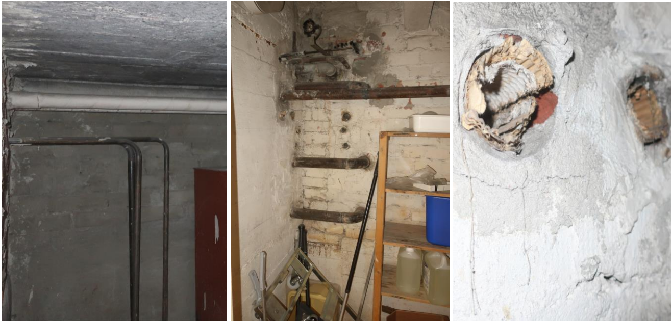
Kuvat 1, 2 ja 3. Öljysäiliötilassa oli asbestipitoisia putkieristeitä. Putkien läpivienteihin oli jätetty asbestipitoisia eristeitä.
