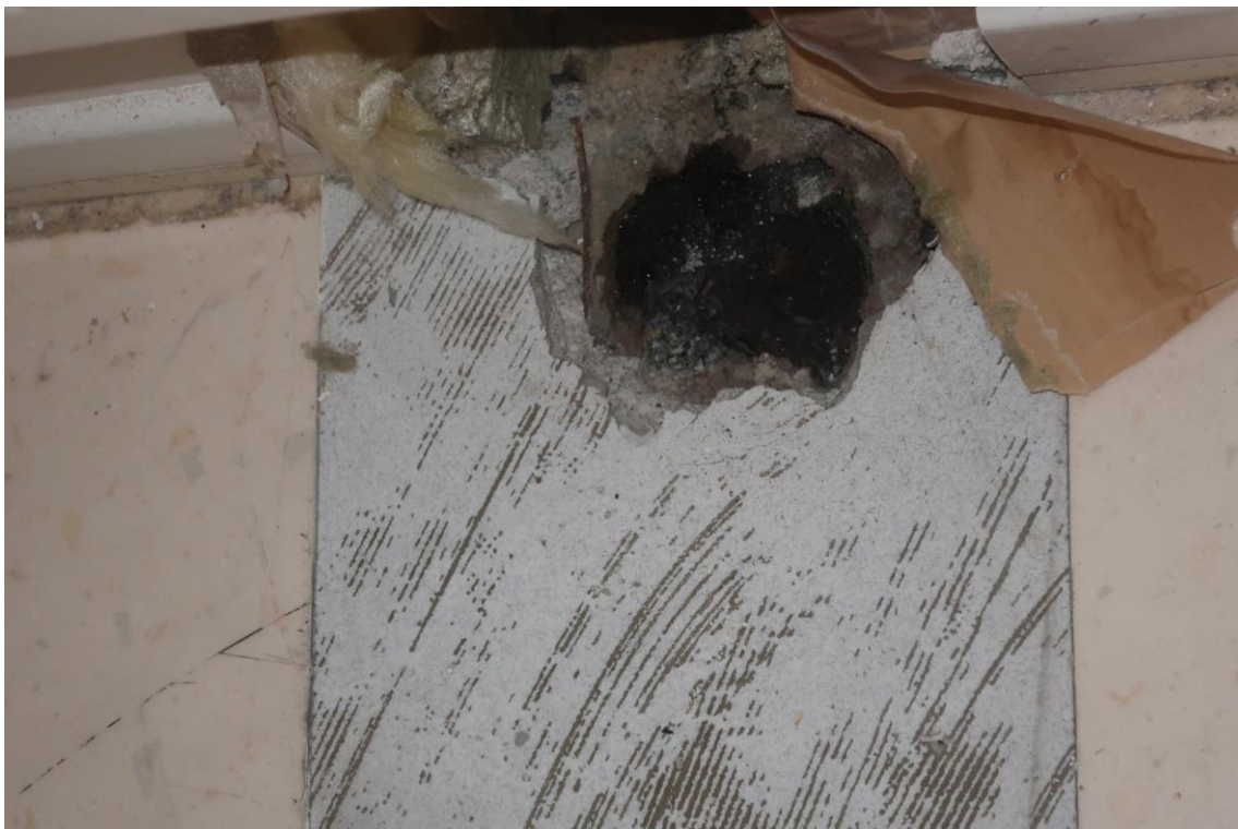
Kuva 15. Toisen kerroksen entisen nukutusparvekkeen lattian vedeneriste sisältää asbestia.
