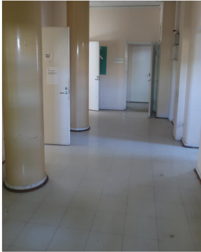
Kuva 12. Tilan 132 (tila jaettu neljäksi eri tilaksi) vinyylilaattojen alle oli jätetty mustaa asbestipitoista pikiliima.
