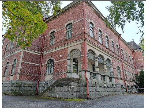
Pohjois- ja länsipuolen kulma, terrassin katossa halkeilua
