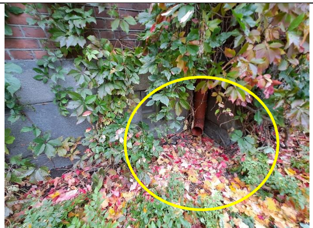
Sadevesikaivon ritilä täynnä lehtiä, joka estää sadeveden hallitun poiston rakennuksen viereltä
