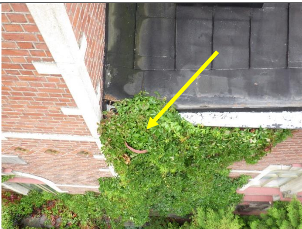
Köynnöskasvusto lähes tukkinut syökytorven yläosan itäisellä julkisivulla
