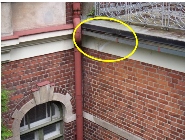
Räystäskouru vuotaa vesiä ulkoseinälle
