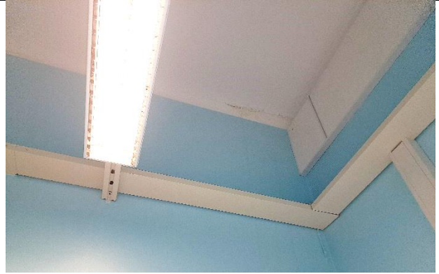
Sisäkattopinnoilla vauriojälkiä vesikatteen vesivuodoista (2.krs)
