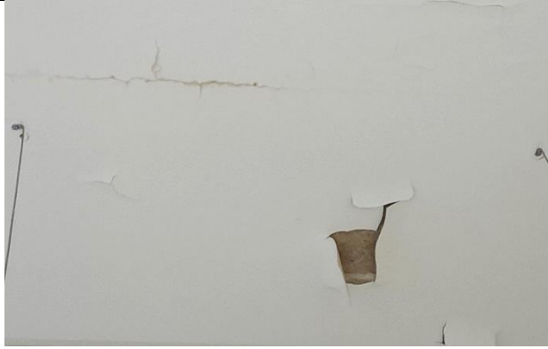
Sisäkattopinnoilla vauriojälkiä vesikatteen vesivuodoista (2.krs)
