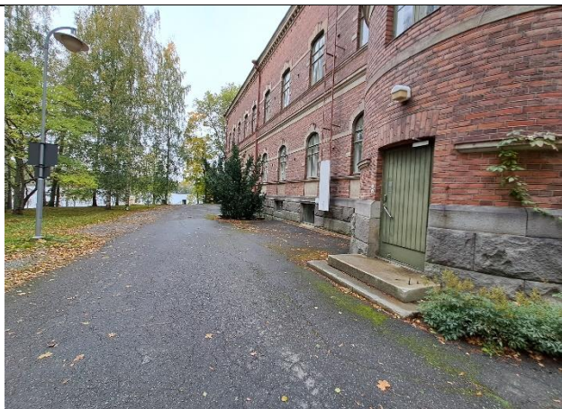
Asfaltin pinnassa maan elämisen jäljiltä kohoumaa, joka paikoin kaataa kohti rakennusta
