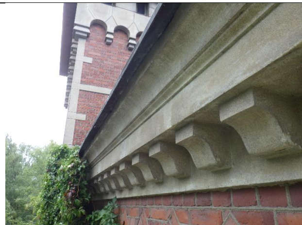
Räystäät rapattuja. Räystäsrakenteissa paikoin alkavaa halkeilua
