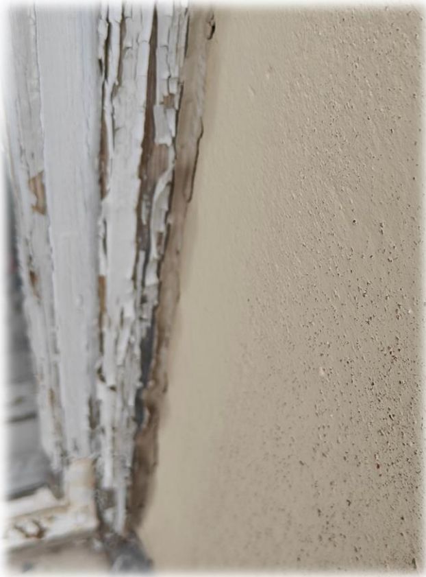
Kuva 7 Ikkunoiden puuosissa havaitaan voimakasta hilseilyä
