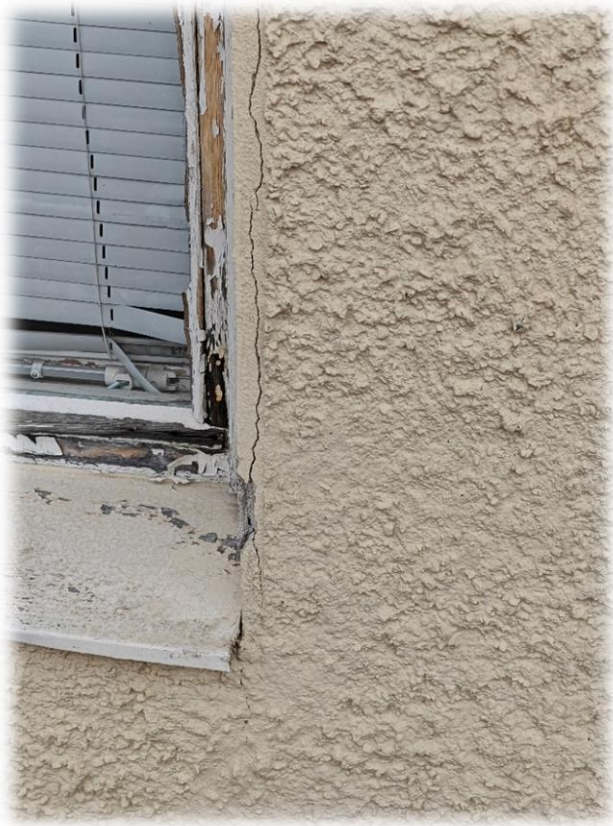
Kuva 10 Ikkunapelitejä ei ole asennettu rappauskanttiin
