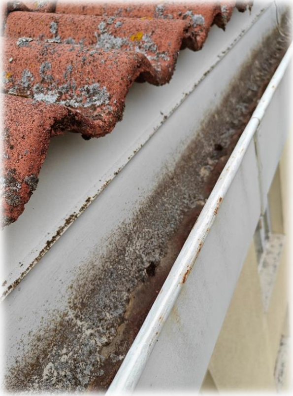
Kuva 11 Kourujen sisäpuolet ovat osittain ruosteessa
