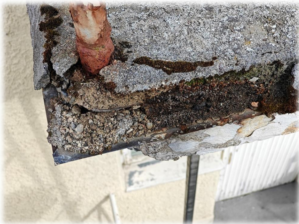
Kuva 16 Pintalaatta havaittiin etureunasta täysin pakkasrapautuneeksi.
