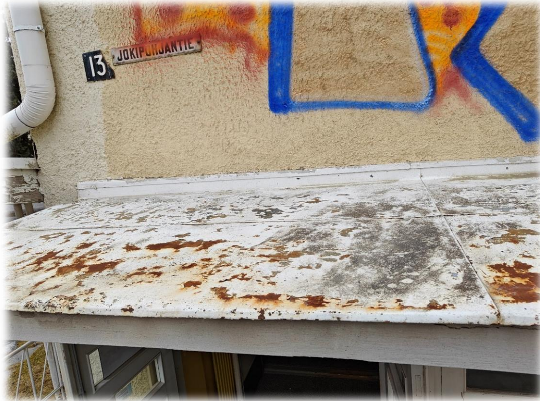
Kuva 9 Katoksien ylösnostot ovat puutteellisia ja pellitykset heikkokuntoisia
