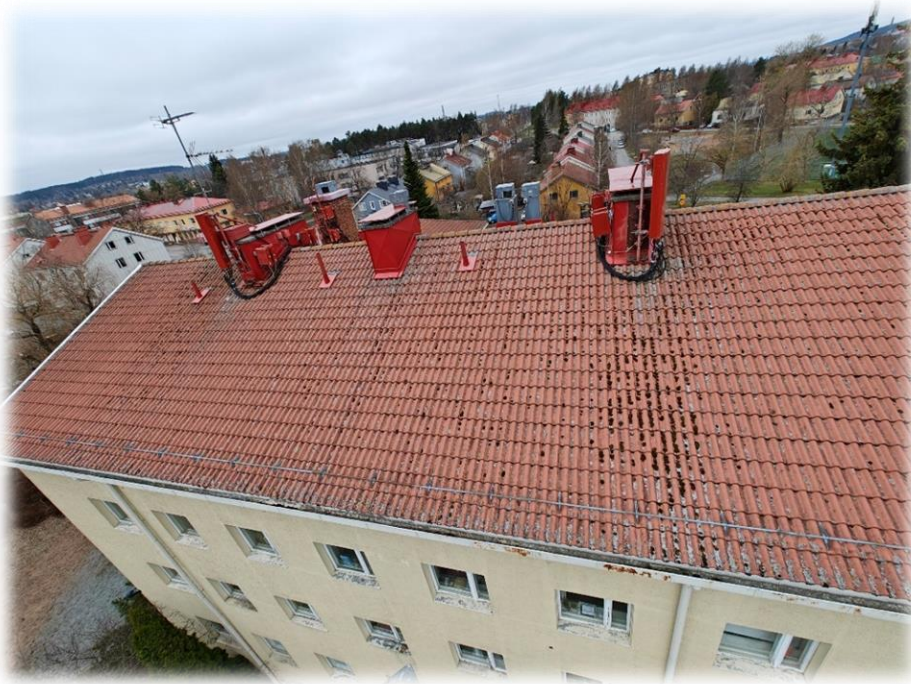
Kuva 13 Vesikatoilla on sammaloitumista
