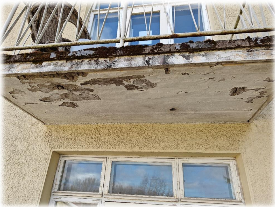
Kuva 18 Alapinnan teräkset pinnassa ja teräskorroosiovaurioituneita.
