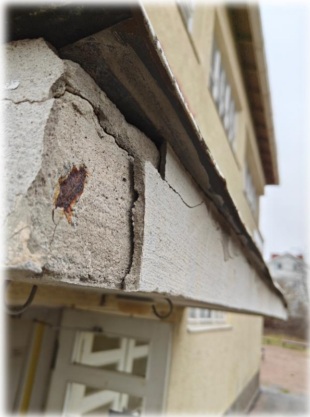
Kuva 8 Katoksien betonisissa otsapinnoissa on havaittavissa teräskorroosiovaurioita.
