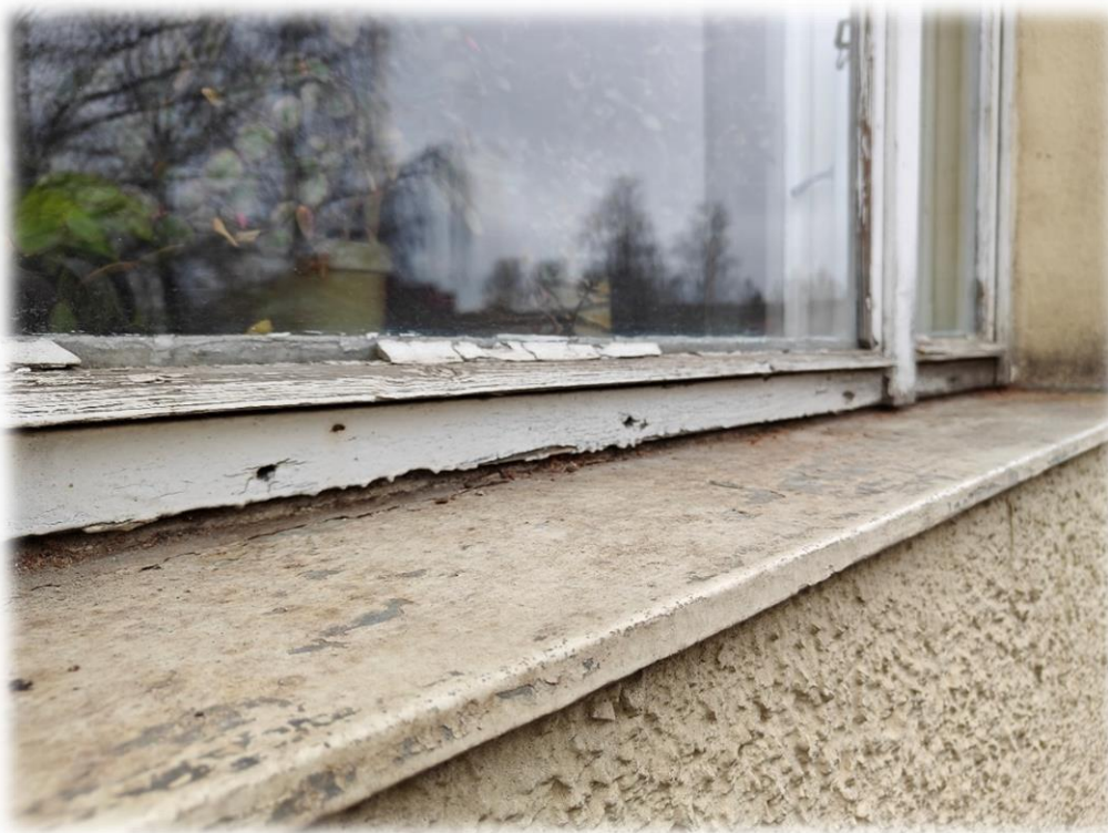
Kuva 6 Alkuperäisten ikkunoiden vesipellityksien kaato on puutteellinen, ikkunat ovat heikkokuntoisia
