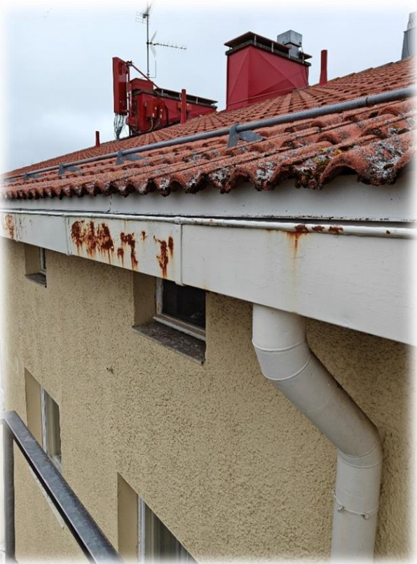
Kuva 12 Kouruissa on havaittavissa ruostumista
