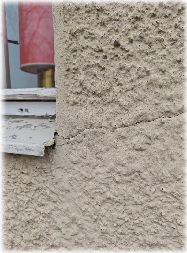
Kuva 2 Tyypillinen ikkunan pielestä lähtevä halkeama
