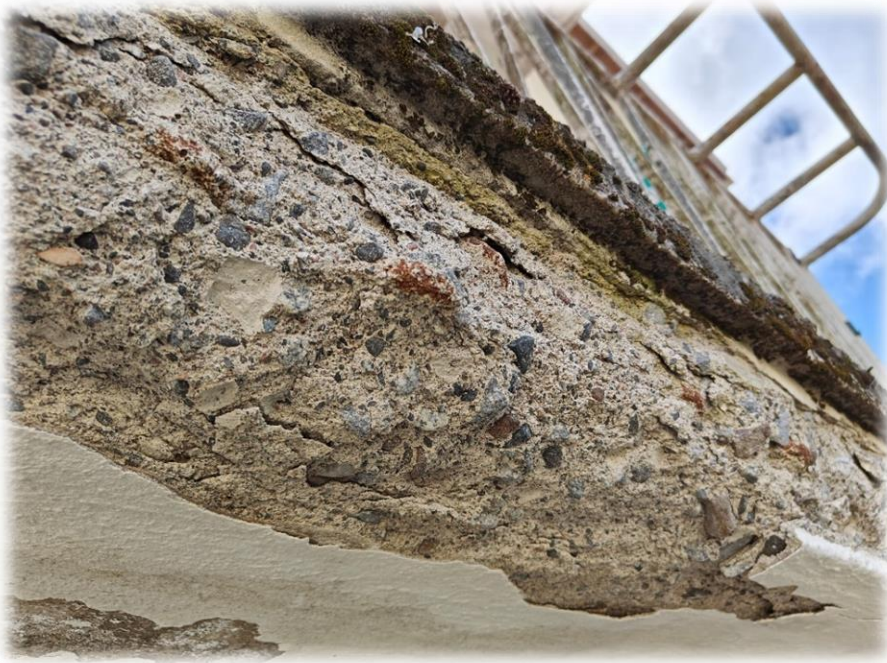
Kuva 19 Etureen betonin on pakkasrapautunut.
