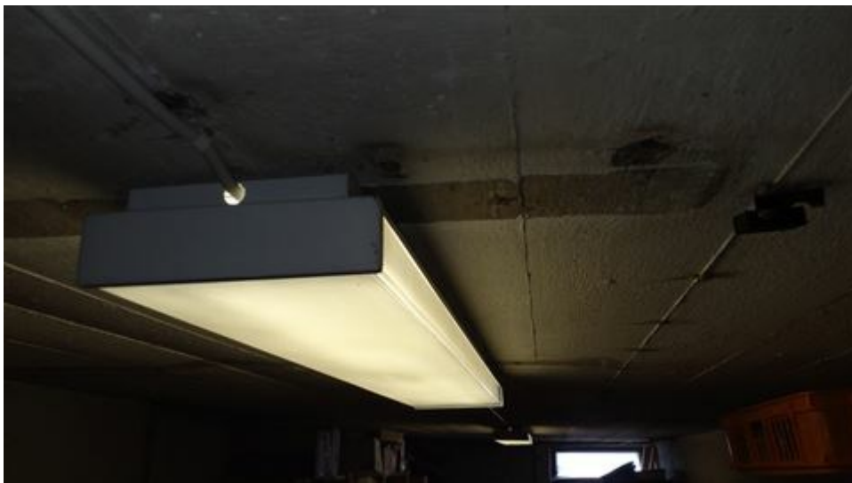
Valaisimet ovat iäkkäitä ja valaistustaso paikoin heikko.
