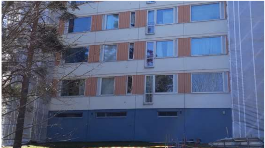
Kuva 25. Ruotulan torneissa olivat ennen korjausta näkyvissä mm. Aarne Heinolle tyypilliset ikkunavälien pystyuritus ja ranskalaisten parvekkeiden sirot pinnakaiteet. kuva Tampereen kaupunki.
