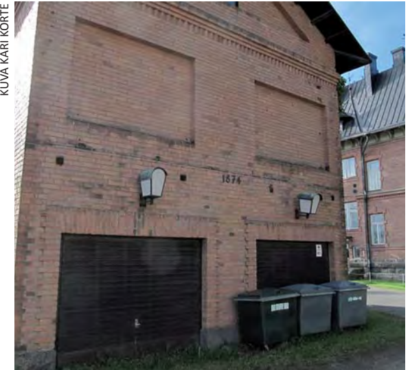
Kuva 15. Kartanon piharakennuksen tiiliseinä, jonka aukossa pesi haarapääsky vuoden 2015 kesällä. Aukko lähellä oikealla olevaa kulmaa, räystään alla.
