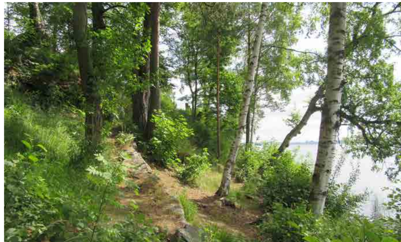
Rantapuustoa ja näköalatasanteelle johtava polku kunnostettavan kivipengerryksen päällä. Pengerrys on 1800-luvun peruja.
