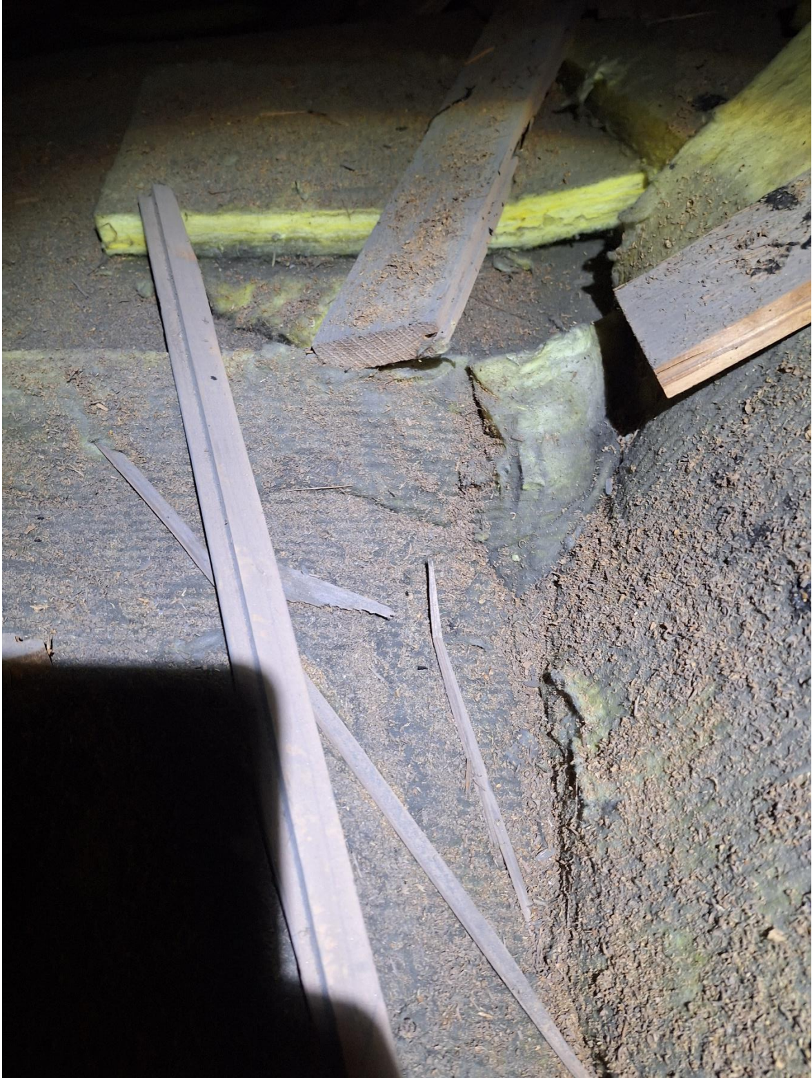
Kuva 3.12. Yksittäisiä lepakon papanoita talousrakennuksen ullakolla.
