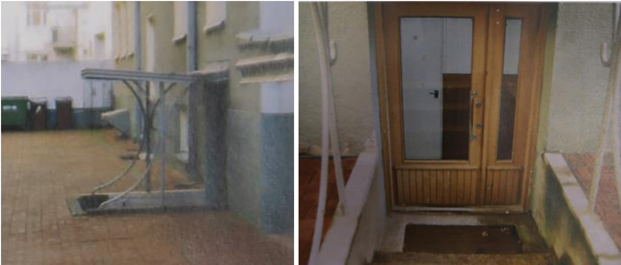
Kuva 25. Kellarien sisäänkäynnit vuonna 2009 ennen uusimista. Sirot katokset ja puuovet. Kuvat raportista Raksystems Anticimex Insinööritoimisto Oy 28.9.2009.
