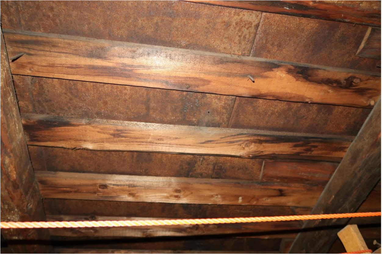
Kuva 46. Pihasiiven alkuperäinen peltikate on alapinnastaan hyvin ruosteinen.
