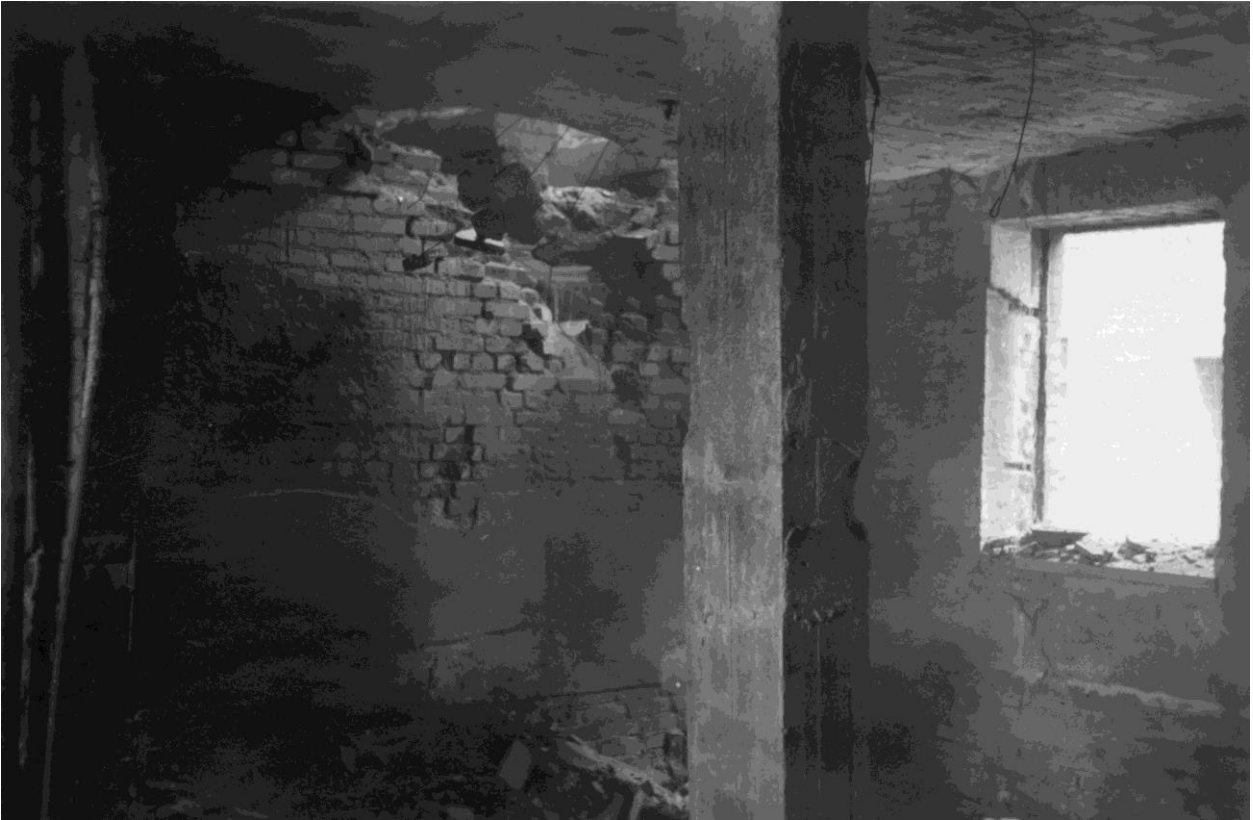
Kuva 14. Pommituksen tuhoja As Oy Sorinmäessä (kolmannessa kerroksessa?). Kuvaaja Bertel Strömmer 2.3.1940. Vapriikin kuva-arkisto. CC BY 4.0
