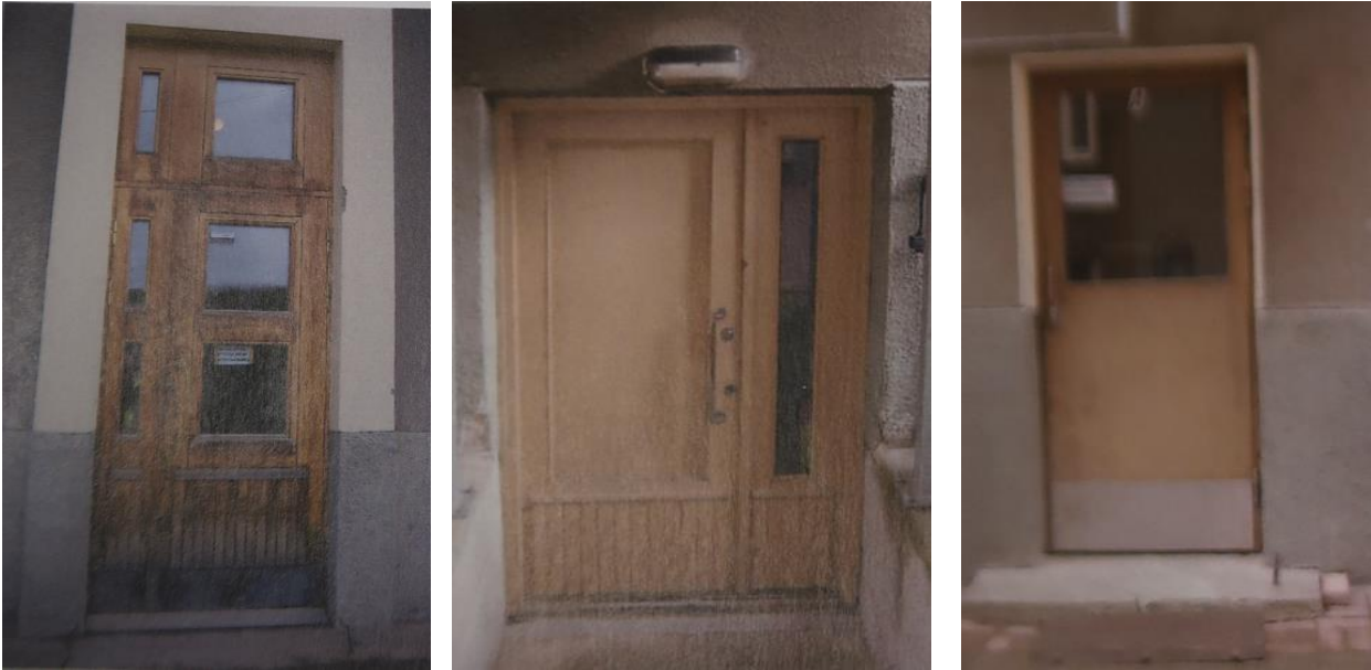
Kuva 27. Ulko-ovet ennen uusimista vuonna 2020: pääulko-ovet, kellarien liiketilojen ja saunan ovet ja takajulkisivujen ovet. Otteet hankeselvityksestä Insinööritoimisto LaRa Oy 6.3.2020.
