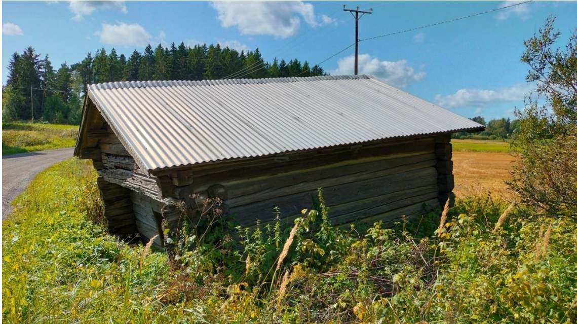
Kuva 46 Otsa-aitta kuvattuna idästä. Aitta on kallistunut tiehen päin. Kallistuman on luultavasti aiheuttanut ojien kaivaminen tien reunoille lähelle aittaa.
