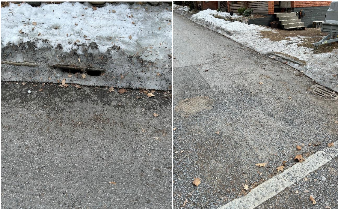
Kuva 17 & 18. Kappelinkadun päässä sijaitsevan nykyisen hulevesiviemärin kitakaivo sekä ritilä- kaivo ja tarkastuskaivo. (Lähde: Ramboll Finland Oy)
