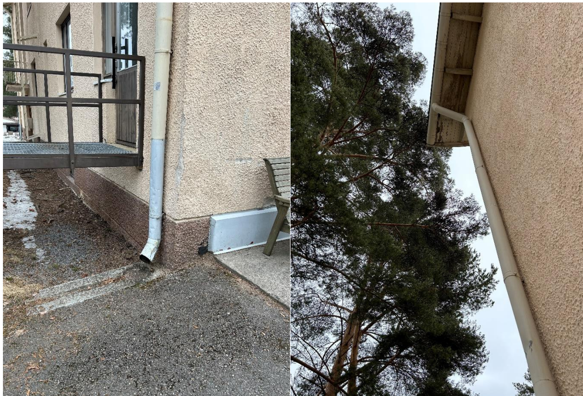
Kuva 9 & 10. Seurakuntatalon rakennuksen kattokuivatuslinja ja syöksyputki. Syöksytorvista vesi purkautuu maanpinnalle eikä rakennuksella ole rännikaivoja. (Lähde: Ramboll Finland Oy)
